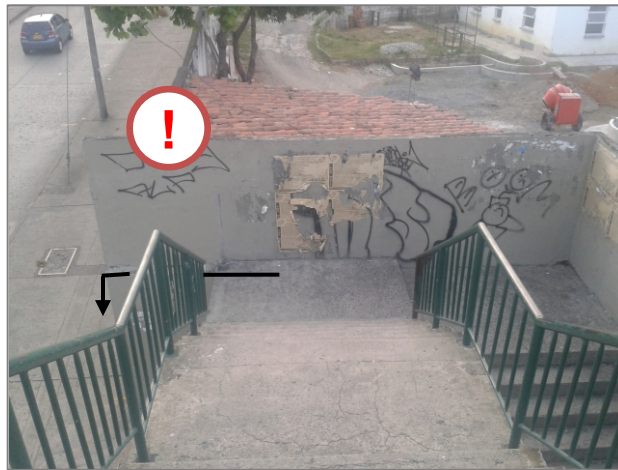
Fig. 3-15. Puentes dañados constituyen un riesgo para la vida de las personas; además las escaleras hacen difícil (o imposible) movilizarse por este medio. CL5/23 - Et. Santa Librada.
