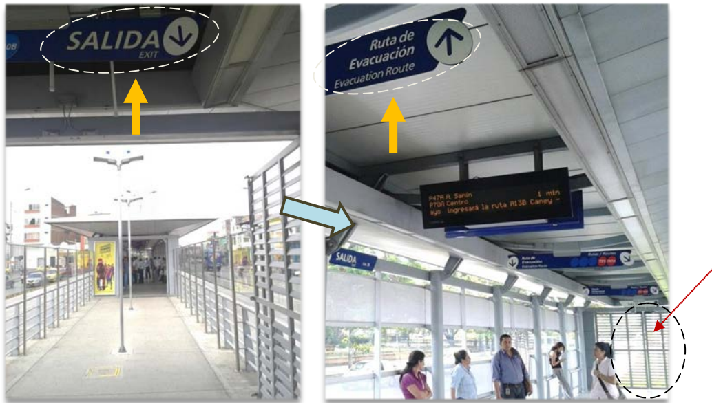
Fig. 4-15. Señal “Salida” indica hacia un lugar donde no hay salida. Et. San Bosco (izq.) Señal “Ruta de Evacuación” indica hacia una pared metálica. Et. Plaza de Toros (der.)
