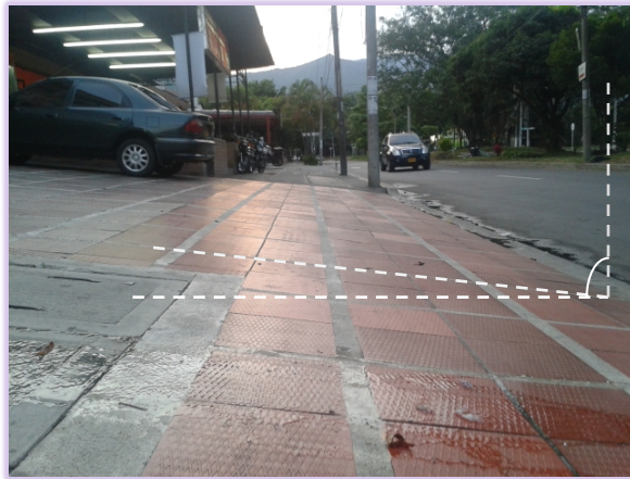
Fig. 3-11. Andenes lisos e inclinados constituyen la amenaza para la salud de los peatones. CL44N entre Av. 3 y 4.
