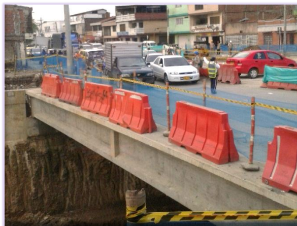
Fig. 3-9. Condición de un paso peatonal sobre el Troncal Aguablanca.
