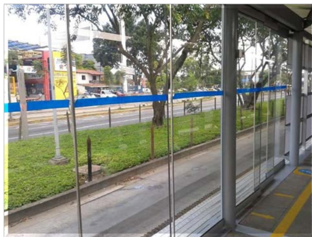
Fig. 4-17. Indicaciones ausentes en las puertas de las estaciones. Et. Vipasa.
