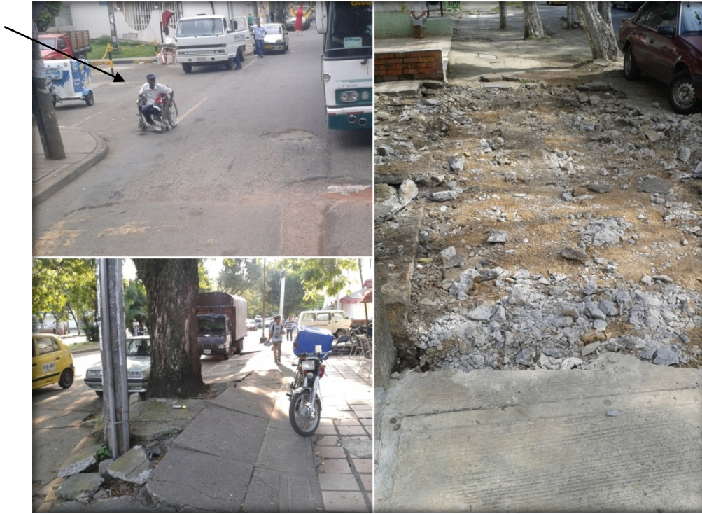
Fig. 3-10. Estado de los andenes alrededor de los PED MIO.
