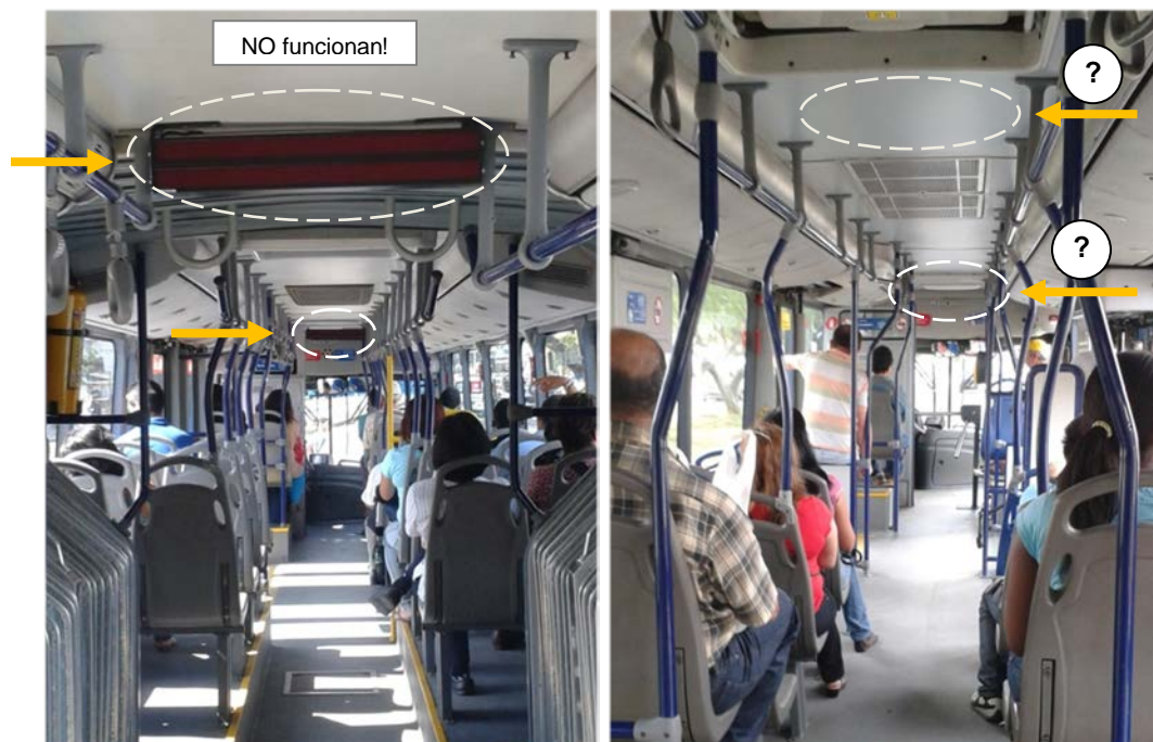
Fig. 4-20. Paneles LED internos no se encuentran (der.) o no funcionan (izq.)
