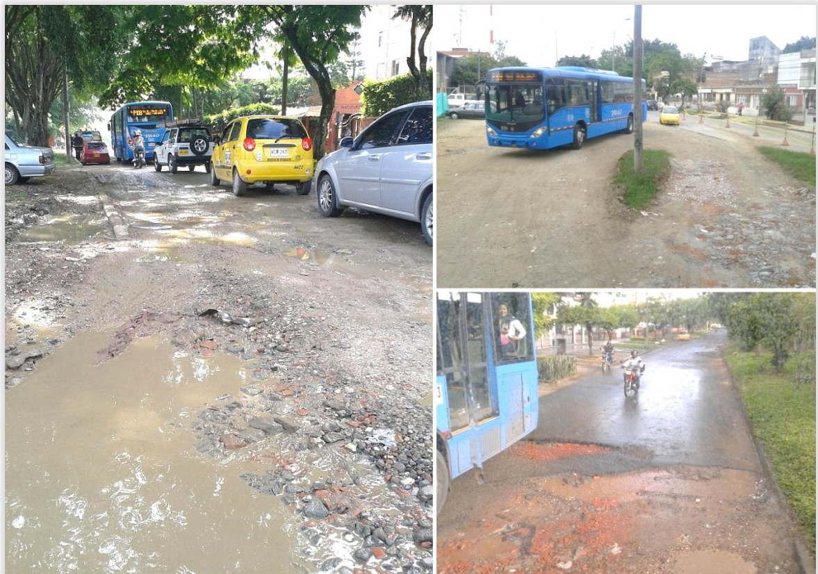
Fig. 2-15. Estado de pavimento vial por donde pasan los buses MIO.
