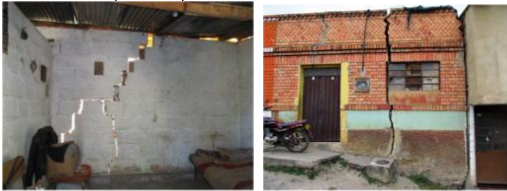
Figura 3-5: Fotografías que muestran ejemplos de daños en viviendas del casco urbano del municipio de Cáqueza.
