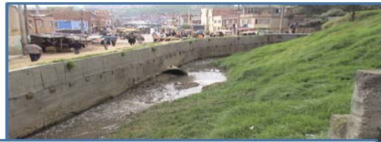
Quebrada Limas se presenta alta contaminación de la quebrada, los desechos arrojados y el mal olor, así como la construcción de muros de contención para prevenir posibles inundaciones.
