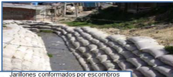
Jarillones conformados por escombros inestables generando taponamiento del Río Tunjuelo.
