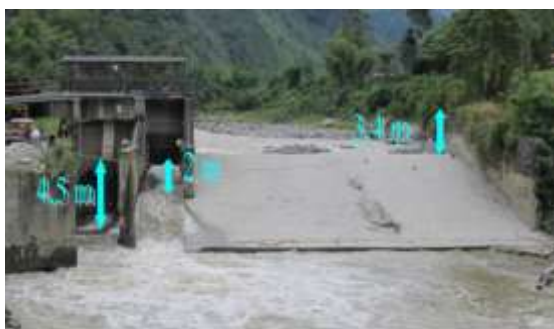
Fotografía 10.5. Compuertas y vertedero de la bocatoma de Montevideo. Foto: F. González.
