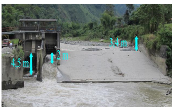
Fotografía 10.5. Compuertas y vertedero de la bocatoma de Montevideo. Foto: F. González.
