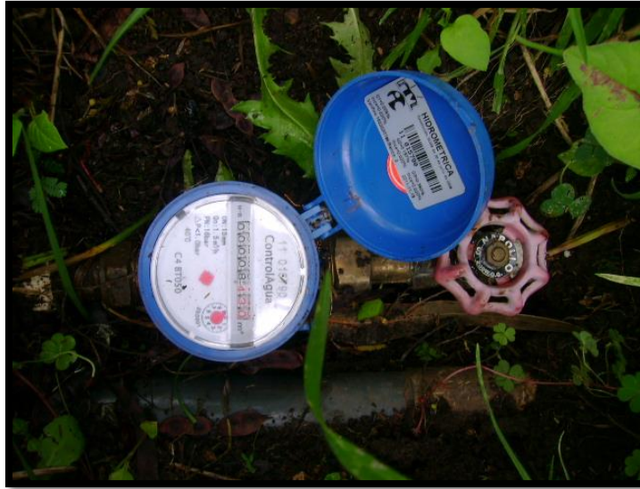
Fotografía 2-2. Contador volumétrico marca Control Agua y válvula de compuerta de 1/2”.
