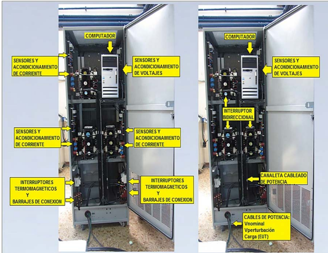
Figura 4-34: Montaje e integración de los módulos en el generador trifásico de perturbaciones de tensión, VISTA DE ATRÁS.
