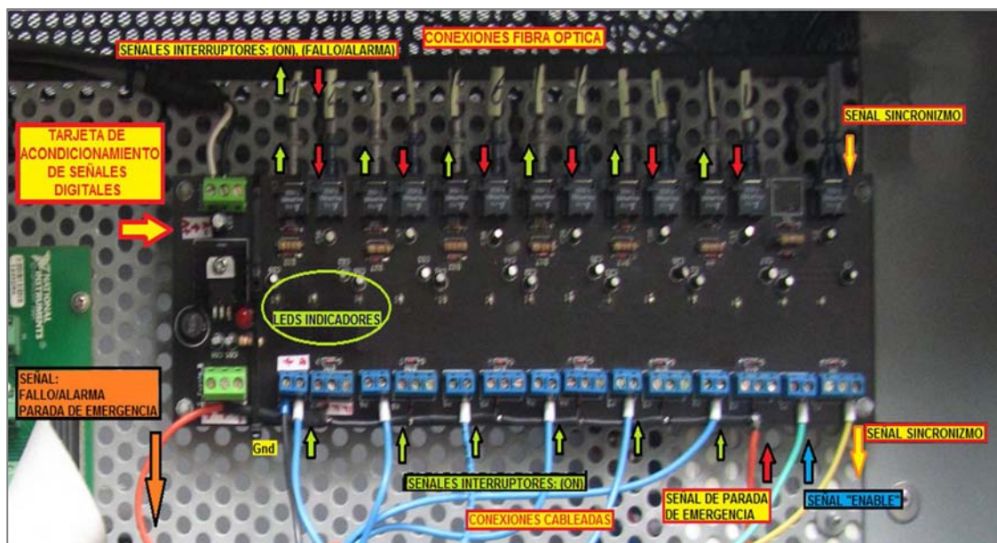
Figura 4-12: Montaje e instalación, tarjeta acondicionamiento de señales digitales.
