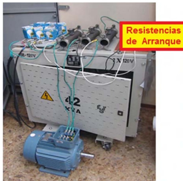
Figura 5-25: Montaje de prueba con carga trifásica: Motor AC trifásico de inducción.
