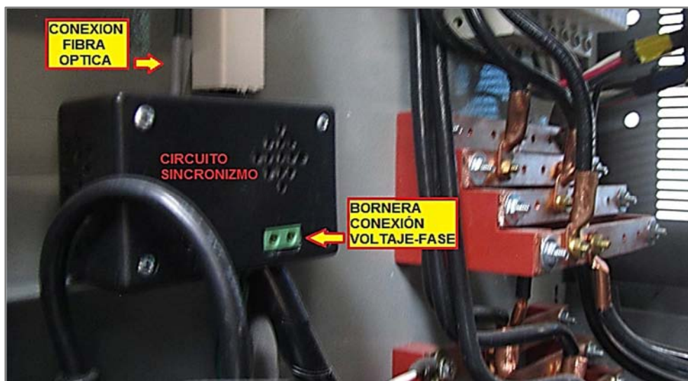
Figura 4-14: Montaje del Circuito de sincronismo con la red eléctrica.
