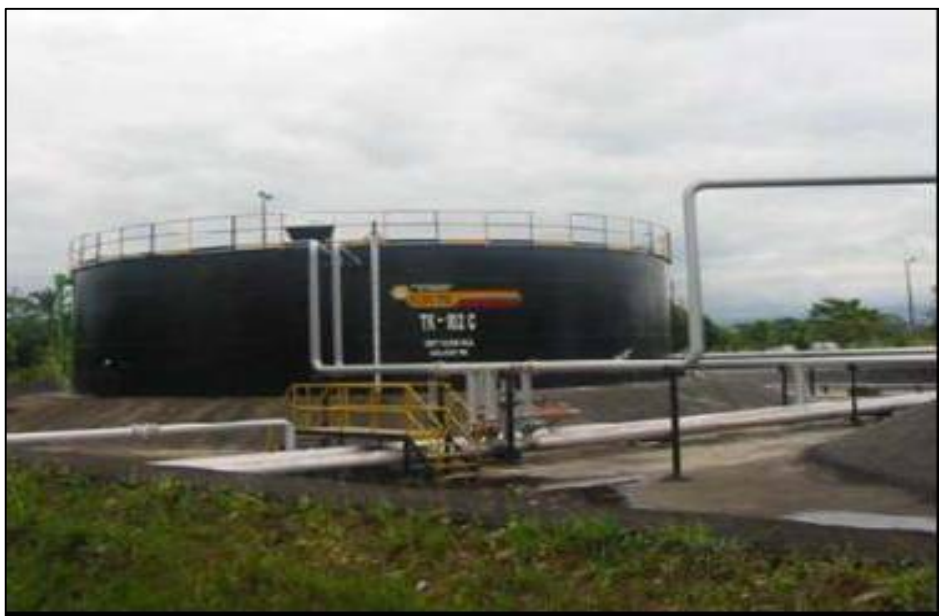
Fotografía A2: Tanque de Almacenamiento.
