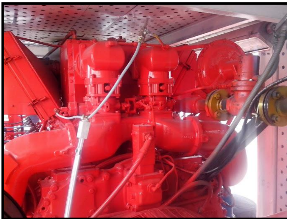
Figura 36: Manometro presión de combustible y de aire Fuente: Ecopetrol – Poilgas
