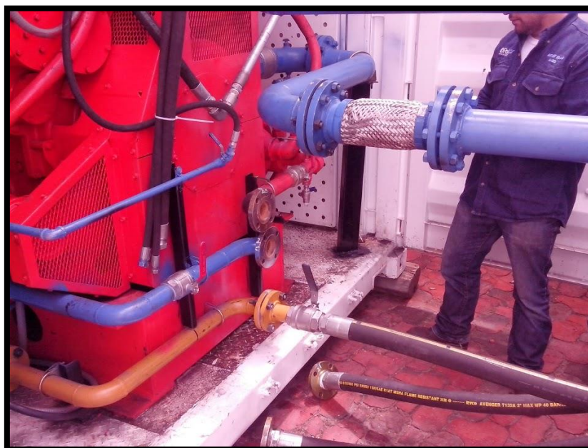
Figura 35: Línea de Suministro de GLP Fuente: Ecopetrol – Poilgas
