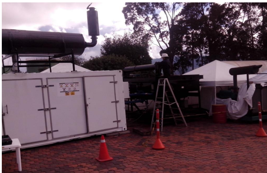
Figura 26: Motogenerador Waukesha acoplado a radiador Fuente: Ecopetrol - Poilgas
