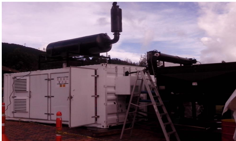
Figura 25: Descripción de Motogenerador Waukesha Cabinado (Blanco) con radiador, exhosto y silenciador (Negro) Fuente: Ecopetrol - Poilgas
