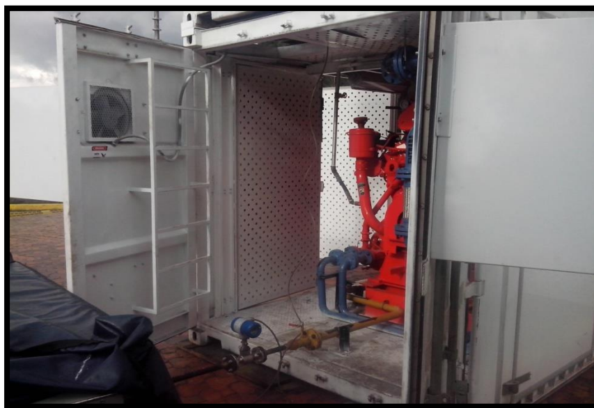
Figura 28: Instalación de medidor de flujo másico para gas Vortex Fuente: Ecopetrol – Poilgas
