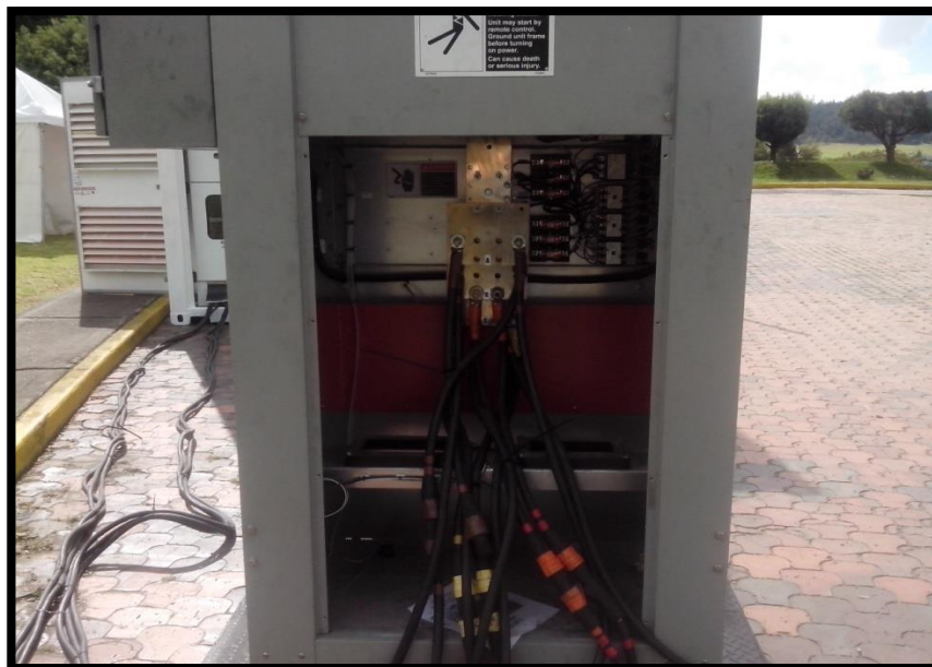
Figura 30: Banco de carga resistivo de 1 MW Fuente: Ecopetrol - Poilgas
