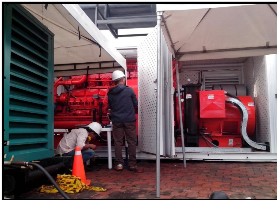
Figura 27: Detalle interno de motogenerador Waukesha acoplamiento motor - generador Fuente: Ecopetrol - Poilgas
