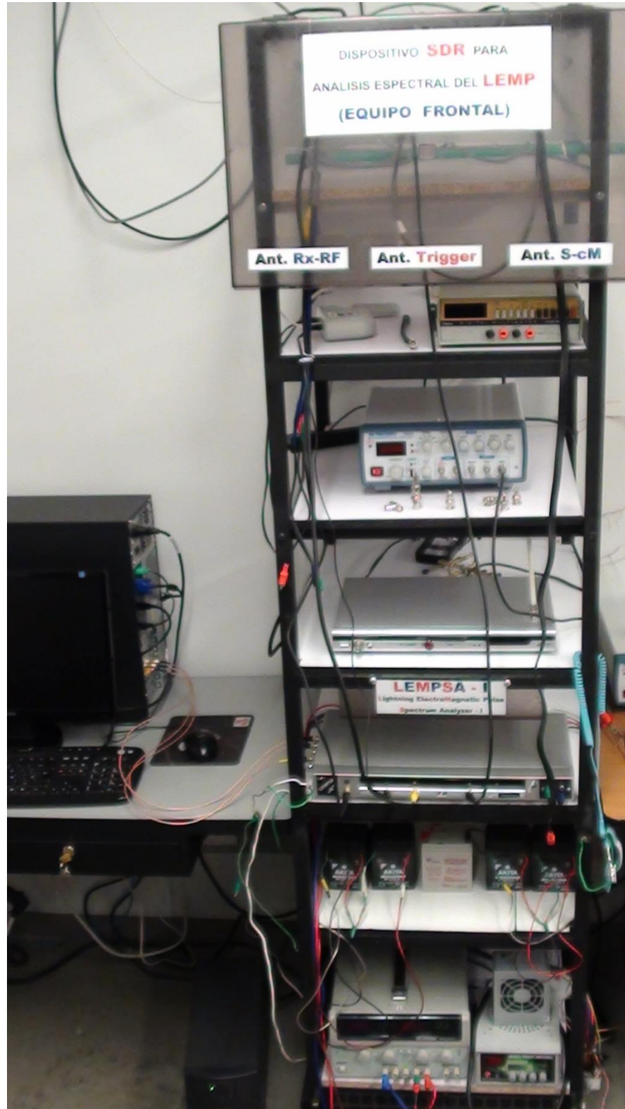
Fig. D.5: Foto Sistema LEMPSA en Bastidor del Laboratorio GTT
