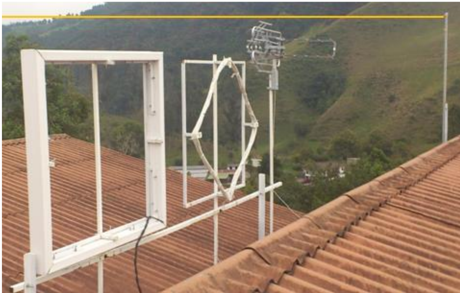
Fig. 7.9: Foto Antenas de lazo implementadas e instaladas sobre el techo.
