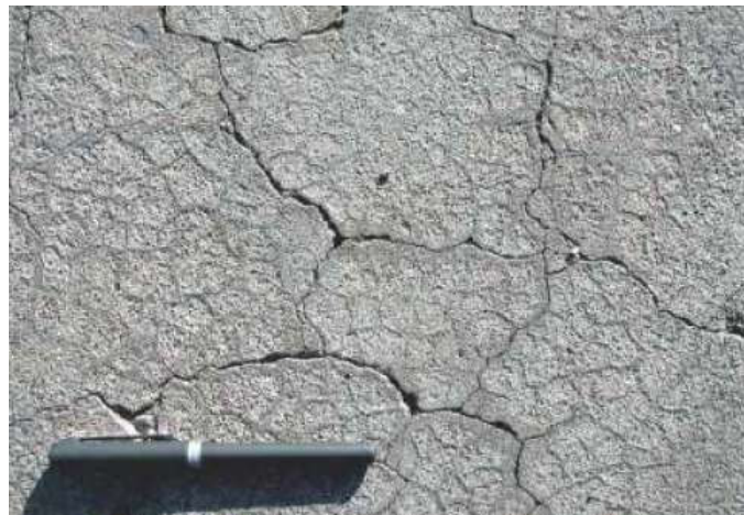
Foto No. 1. Detalle del resultado de un concreto afectado por RAA. (Piel de cocodrilo). Fuente CIP de la NRMCA
