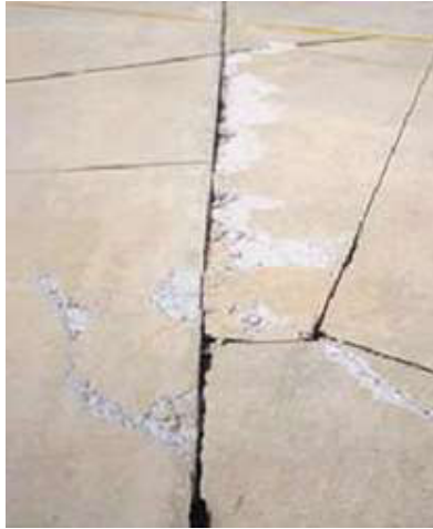
Foto No. 5. Agrietamientos causados por RAS, fuente http://www.construdata.com/BancoConocimiento/T/toxementalcali/toxementalcali.asp
