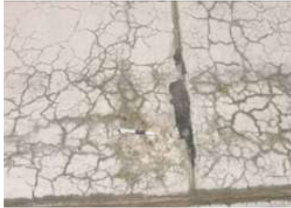
Foto No. 4. Grietas y fisuras en forma de mapa. Fuente
