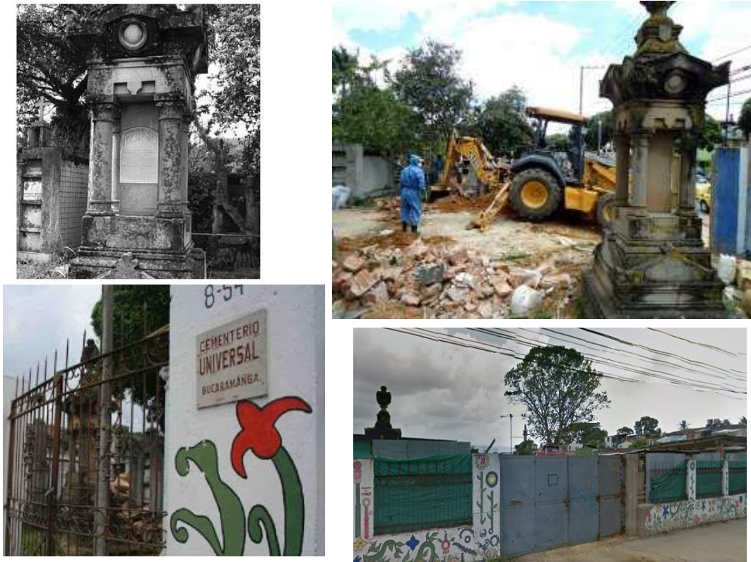
Figuras 4.65, 4.66, 4.67 y 4.68. Cementerio Universal de Bucaramanga antes y durante su demolición en el año 2010.
