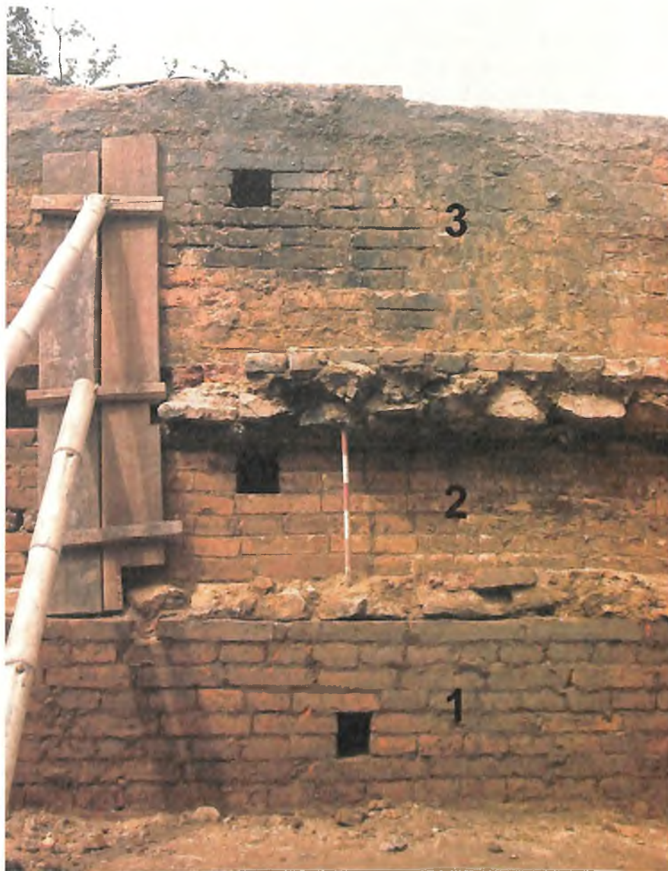
Figura 25. Detalle de las huellas constructivas sobre el muro del estribo sur que mira aguas abajo del río Cali desde el interior del relleno artificial (hoy removido).
