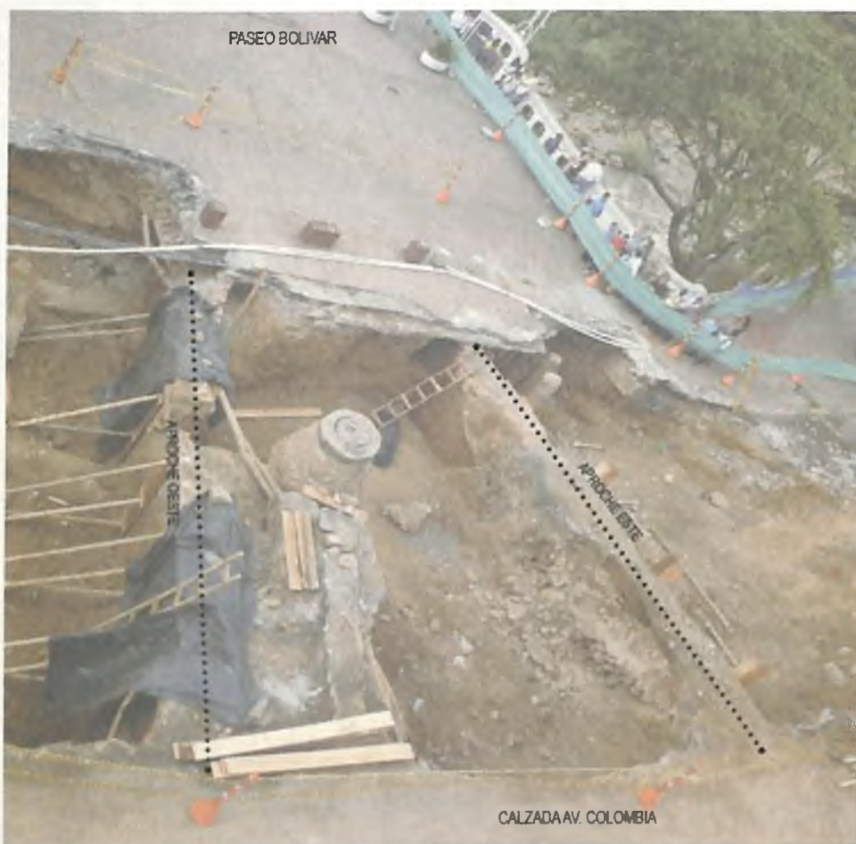
Figura 18. Vista de los dos muros que conforman el estribo sur del puente. A la izquierda, muro que mira aguas arriba. A la derecha, muro que mira aguas abajo.
