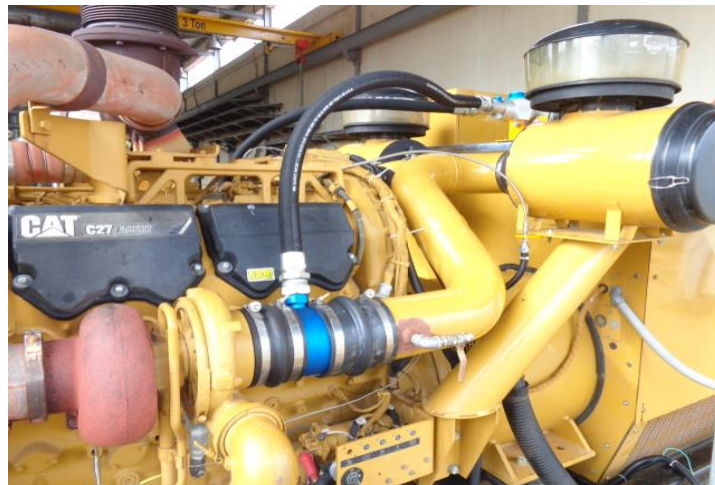
Fotografía 7: Generador C27 (detalle de la entrada de gas al equipo- mezclador)
