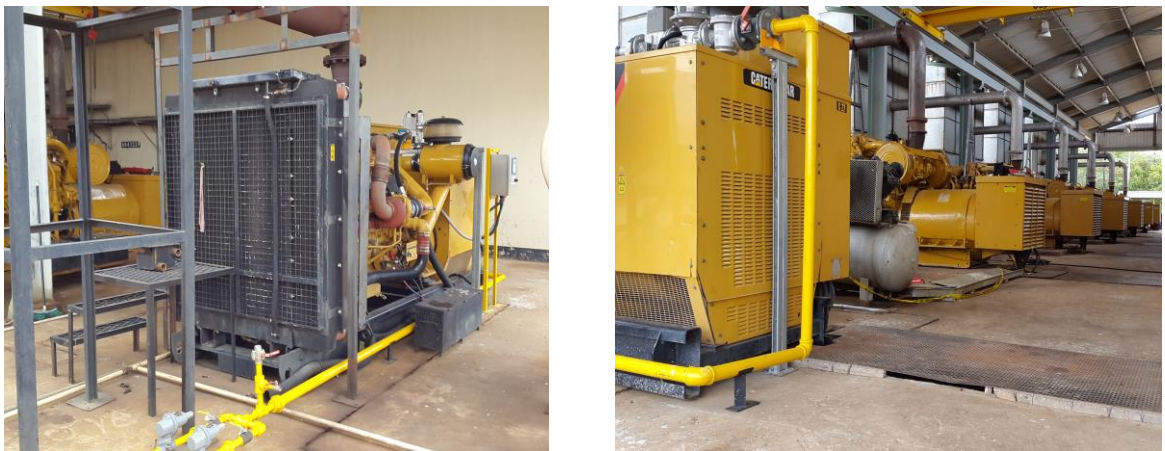
Fotografía 4: Planta C27 con el sistema “ dual-fuel ”
