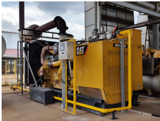
Fotografía 1: Generador a diésel Caterpillar C27
