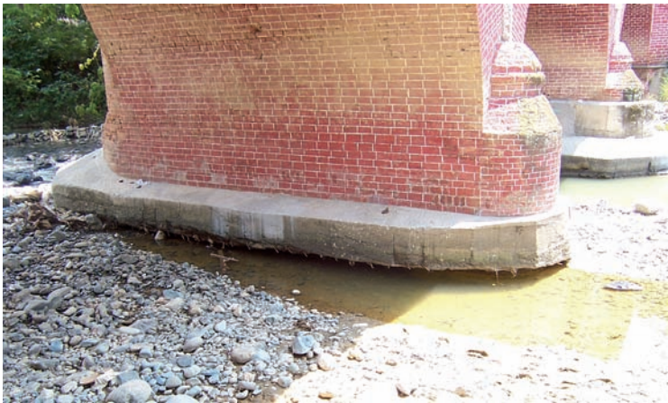
Figura 4.3 Infraexcavación local en las bases del puente sobre el río Guadalajara, en Buga. Foto: J. Galindo (2007).
