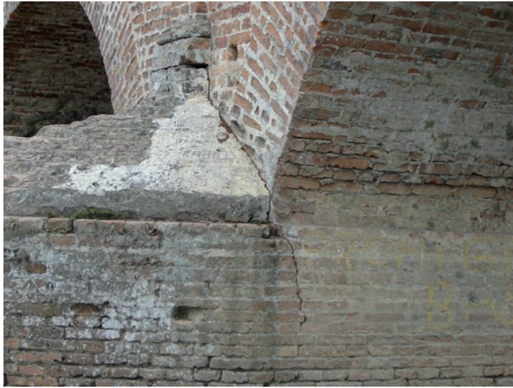
Figura 4.4 Agrietamiento entre pilas y tajamares por movimiento de apoyos a causa de infraexcavación en el puente sobre el río Güengüé. Foto: J. Galindo (2007).
