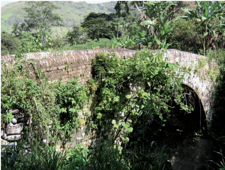
Figura 4.8 Vegetación sobre el puente de Quilcacé.
