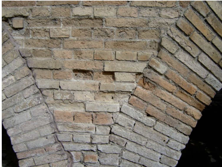
Figura 4.6 Meteorización de ladrillos y morteros en el puente del Humilladero, en Popayán. Foto: J. Galindo (2007).
