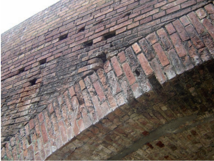
Figura 4.7 Grietas longitudinales en el intradós de las bóvedas del puente de Caloto.
