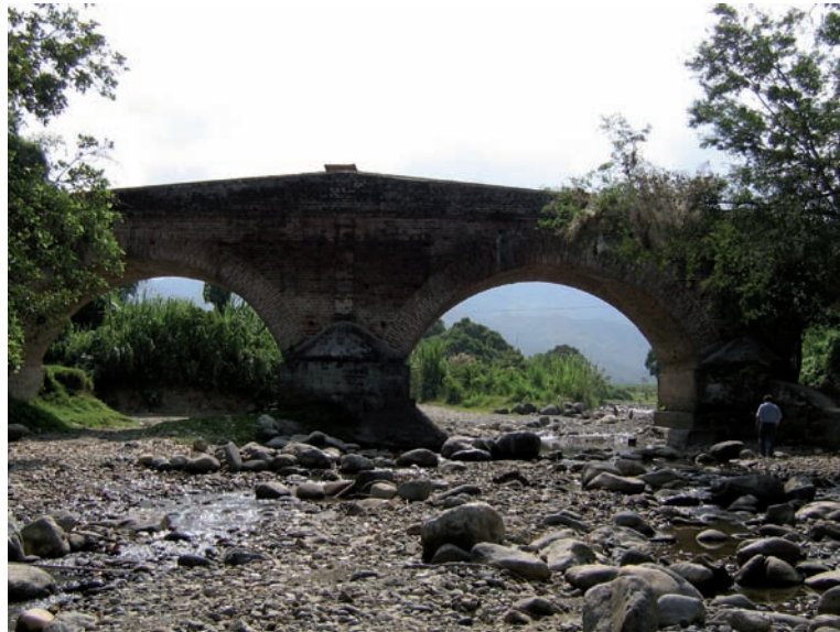
Figura 4.2 Degradación del lecho del río e infraexcavación generalizada en el puente sobre el río Güengüé. Foto: J. Galindo (2007).
