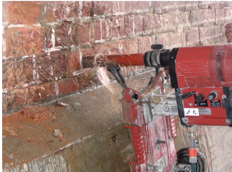
Figura 4.9 Extracción de núcleos en las bases de uno de los arcos del puente de Buga.
