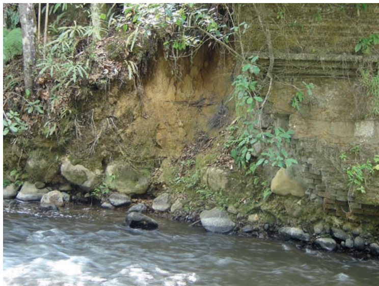
Figura 4.5 Infraexcavación en uno de los estribos del puente sobre el río Cofre. Foto: J. Galindo (2007).
