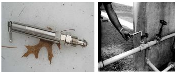
Figura 5-5. Válvula para indicar contenido de humedad en el GLP (Pinzon, N., 2010).
