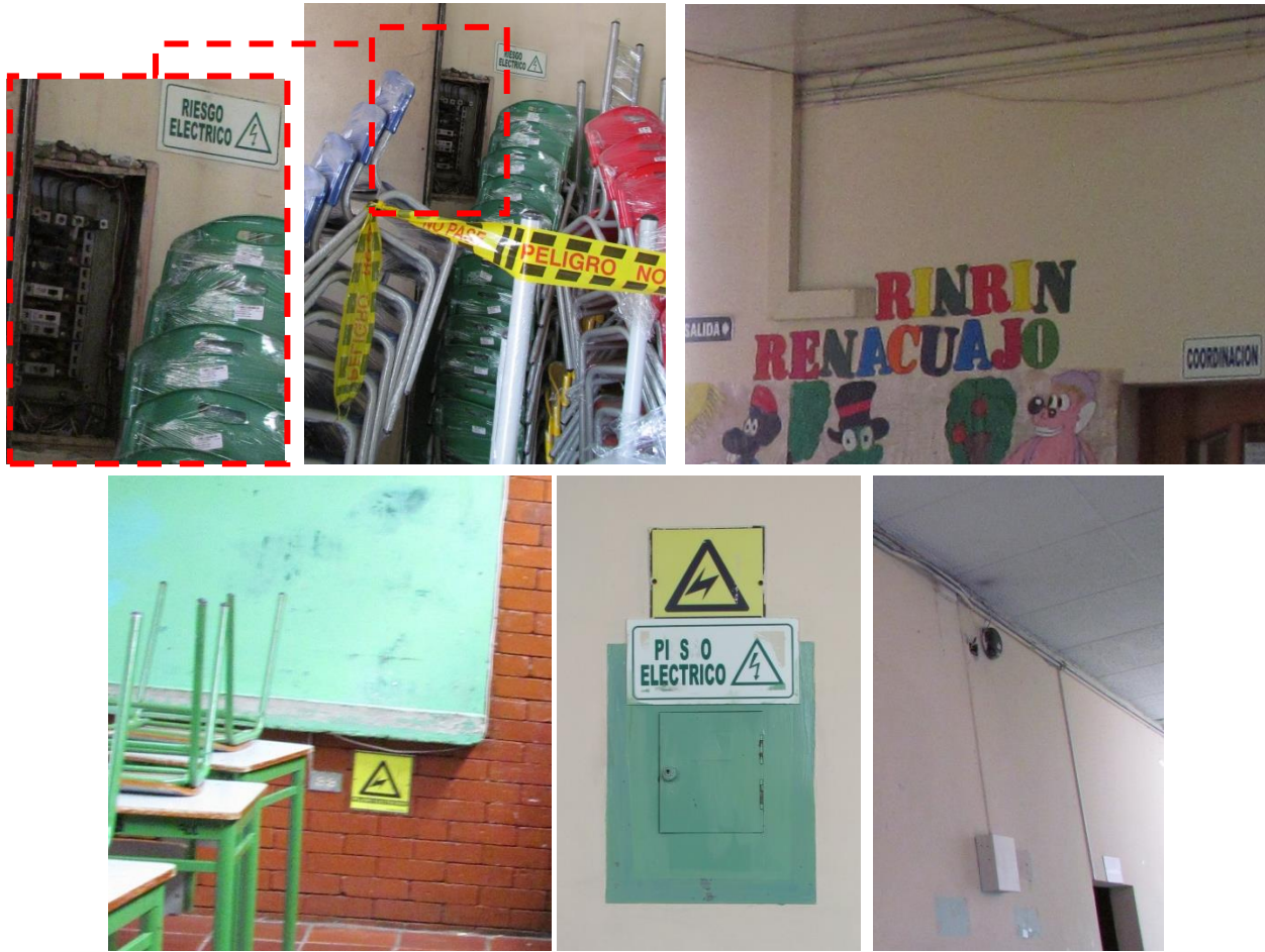
Imagen 274. Elementos de cableado y demás que deterioran la seguridad en las instalaciones del colegio ESNALCO sede Quinta Díaz
