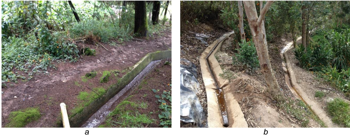
Fotografía 4-4: Tipos de cunetas dentro del relleno sanitario. a) Cuneta de aguas lluvias. b) cuneta de lixiviados
