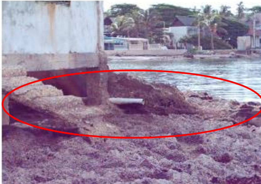
Figura 18. Vertimiento directo al mar en el sector de San Luis
