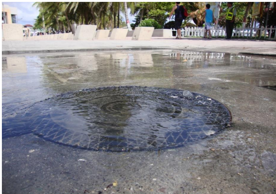
Figura 20. Aguas residuales brotando en "temporada baja" desde la alcantarilla, en plena zona rosa
