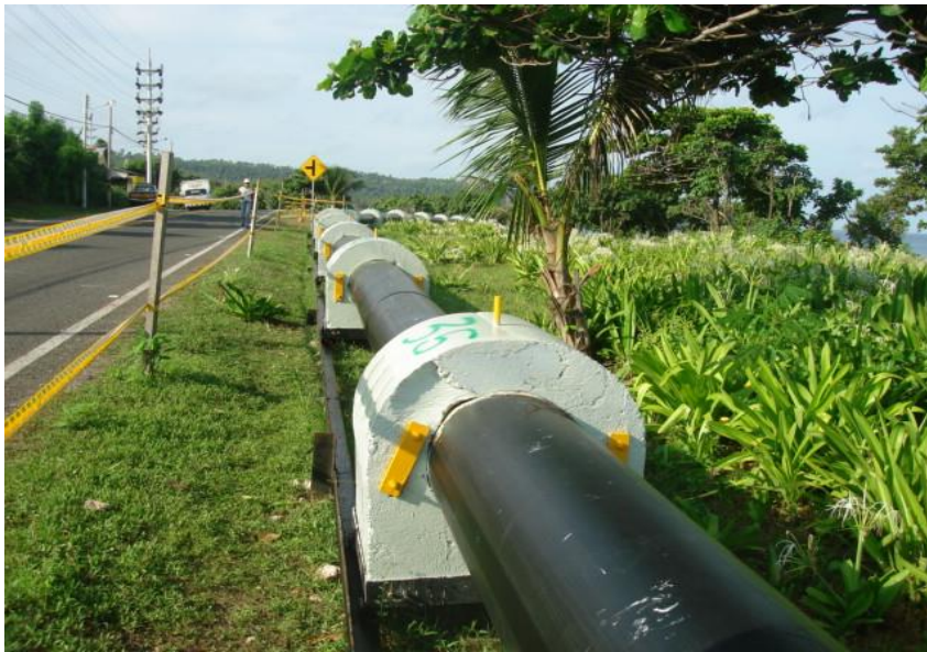
Figura 14. Tuberías del emisorio submarino
