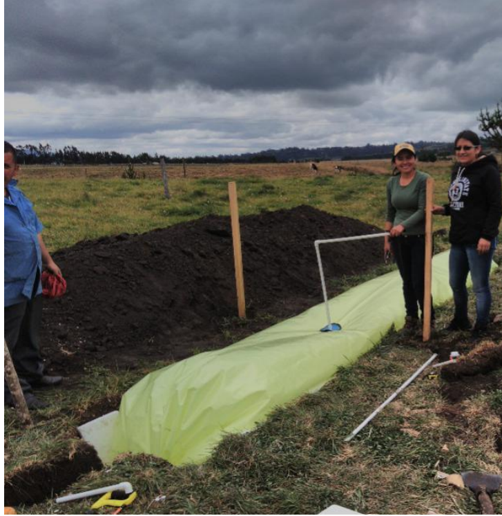
Figura 5-44. Instalación para la conducción del biogás
