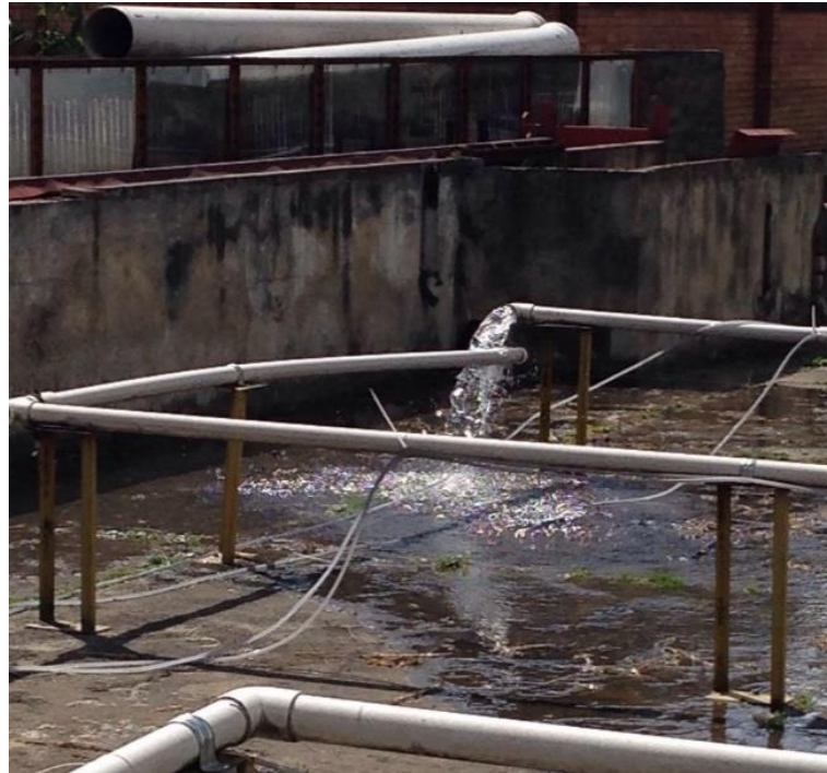
Figura 3-9: Separación entre Codo 90° PVC 1 ½" y Tubería PVC 1 ½".
