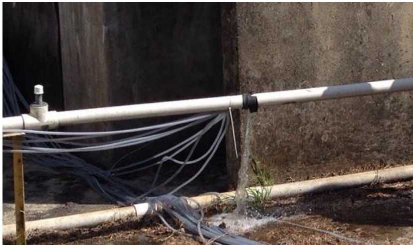
Figura 3-4: Fuga en Tubería PVC 1 ½”.
