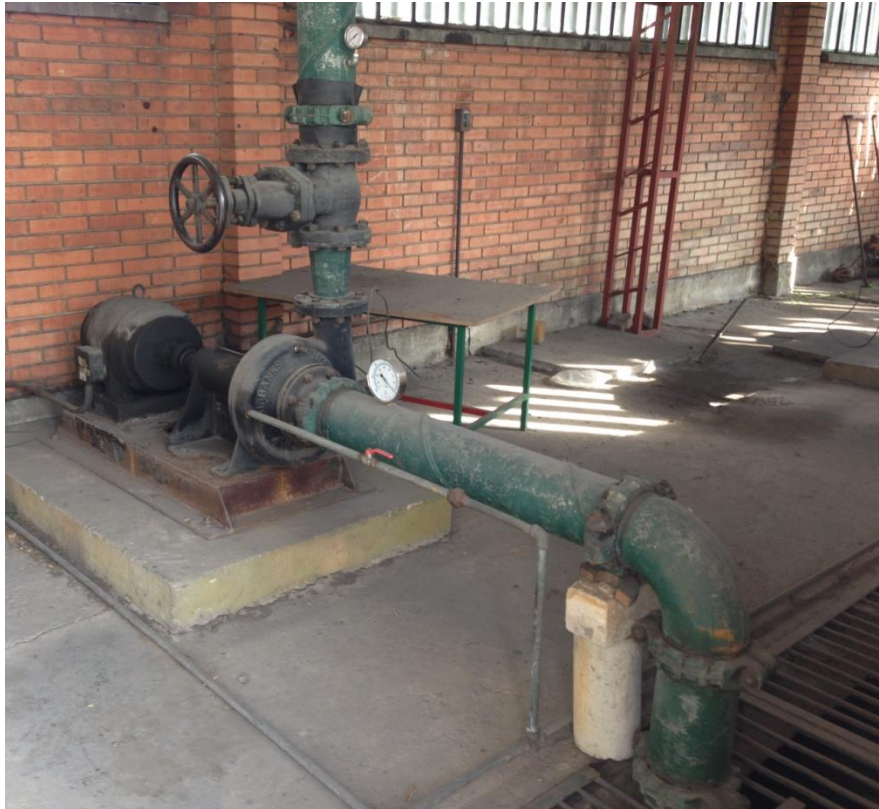
Figura 3-2: Cuarto de bombas.
