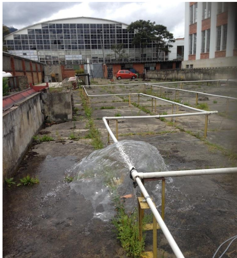
Figura 3-10: Separación entre accesorio PVC Tee 1 ½" y Tubería de 1 ½".
