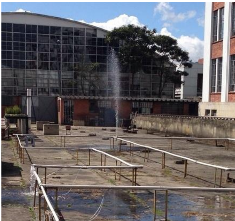
Figura 3-5: Fuga en Tee PVC 1 ½” y separación de tubería \phi 1 ½”.
