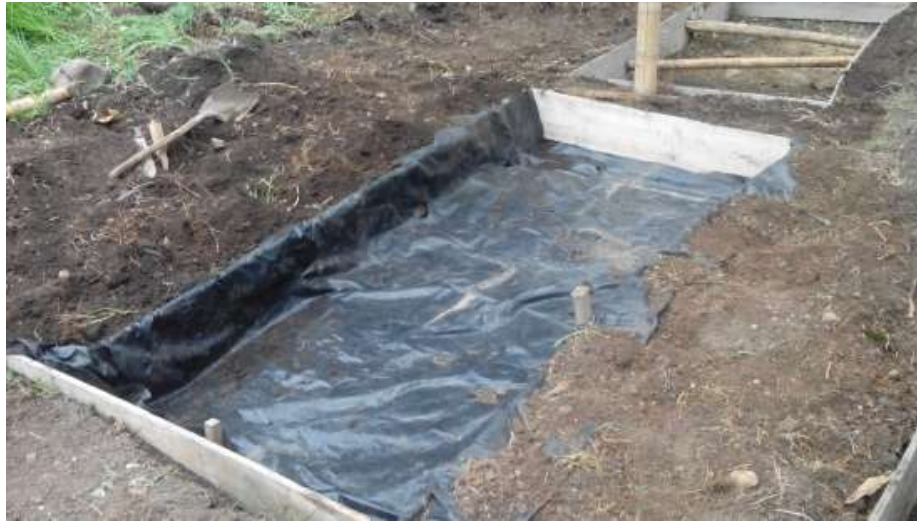
Foto 3. Manejo de lixiviados en la unidad de tratamiento de lechos (UTL)
