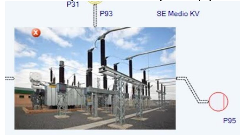
(H) Instalación de SE a mediana Tensión
