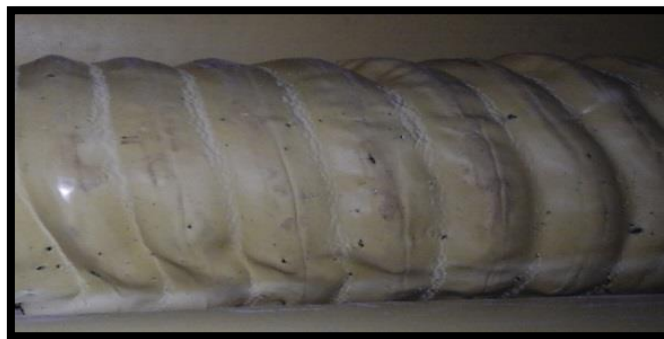
Figura 2-21. Poros en la tubería sanitaria de PVC.
