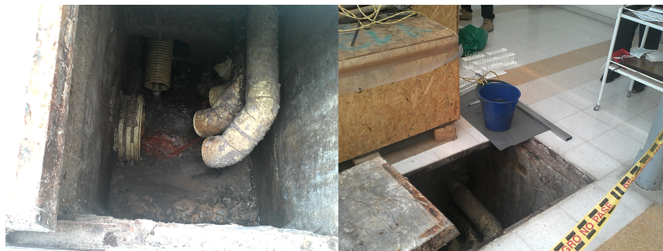
Figura 3.8: Cajilla del INC que recibe el material radiactivo y conecta con el sistema de alcantarillado
