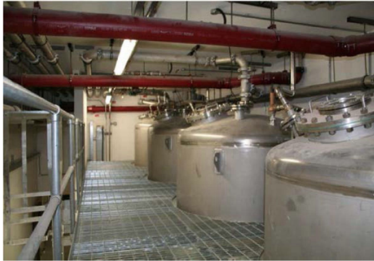
Figura 6.5: Tanques instalados en un hospital de Europa
