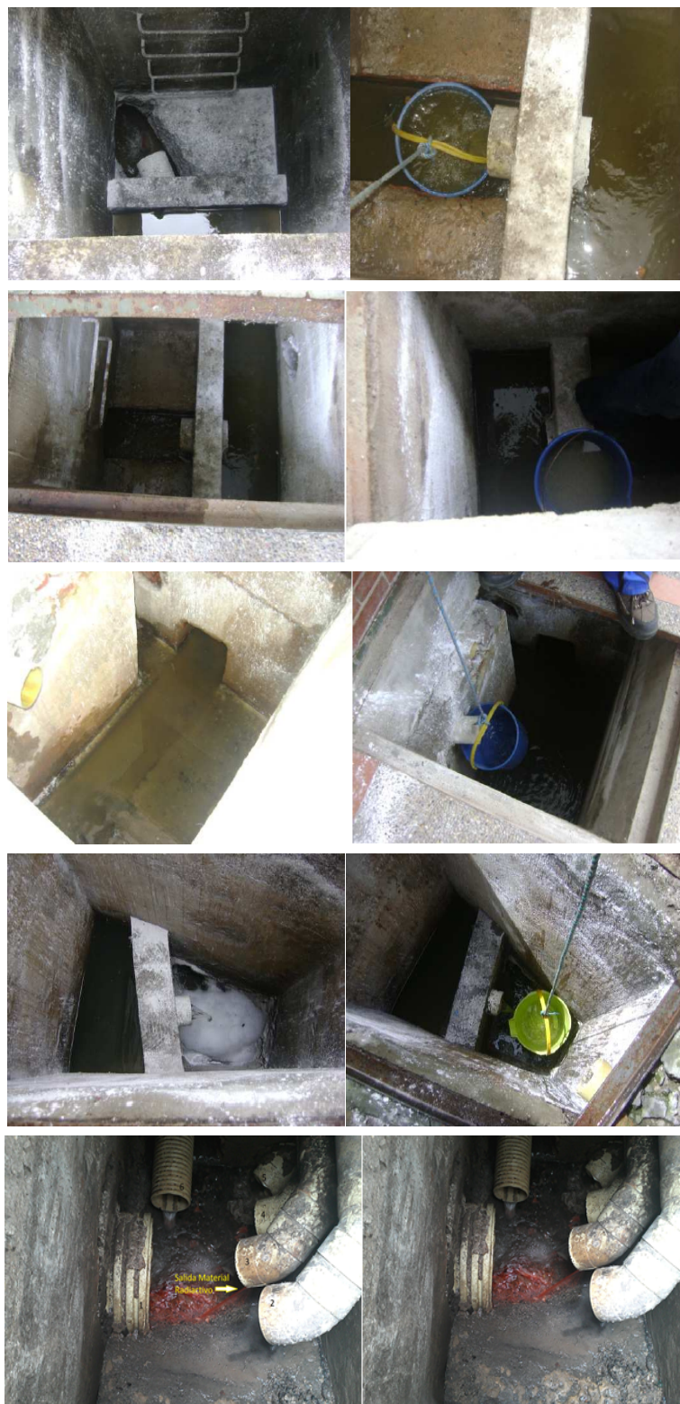
Figura 4.2: Cajas de descarga de aguas residuales del INC que conectan con la alcantarilla pública
