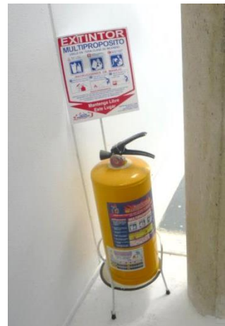
Ilustración 46 Extintor sala 2 (Foto archivo personal)
