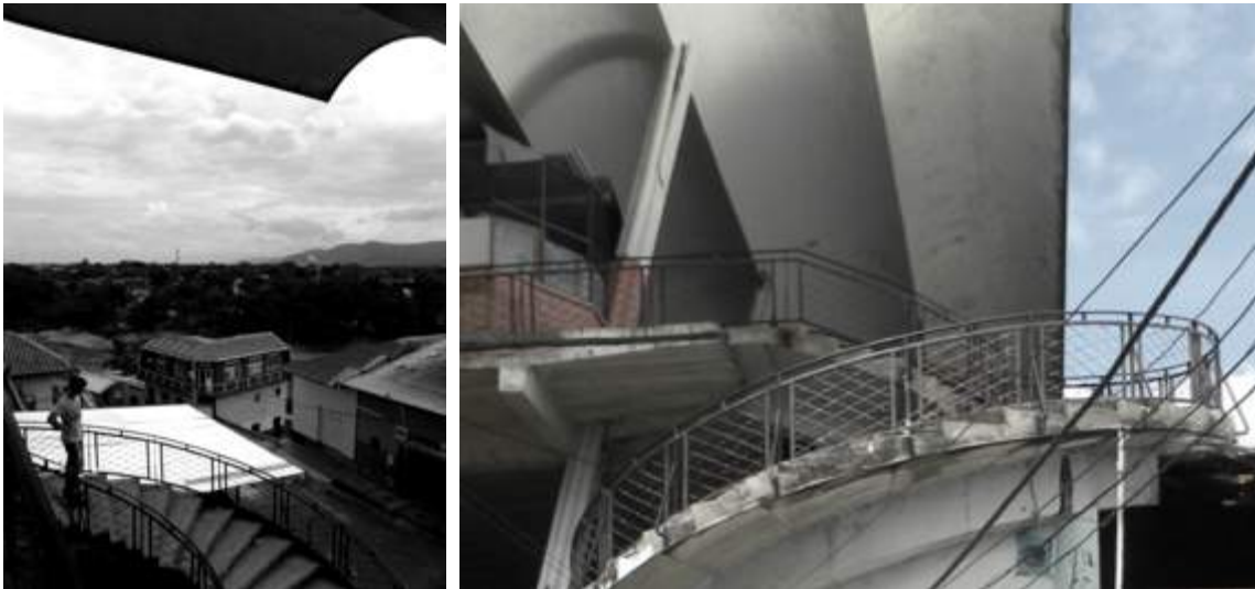
Figura 401 y Figura 402. Imágenes de las escaleras del mercado. Tras casi setenta años, el edificio se encuentra muy deteriorado. Su entorno inmediato también ha cambiado. Las viviendas vecinas fueron modificadas, elevando su altura. En el afán por sacar provecho del suelo, prescindieron de los patios interiores y de la vegetación que los sombreaba. Sin embargo, aún es posible ver el rastro de las intenciones de Rother. (Fotografías de MPA.)
