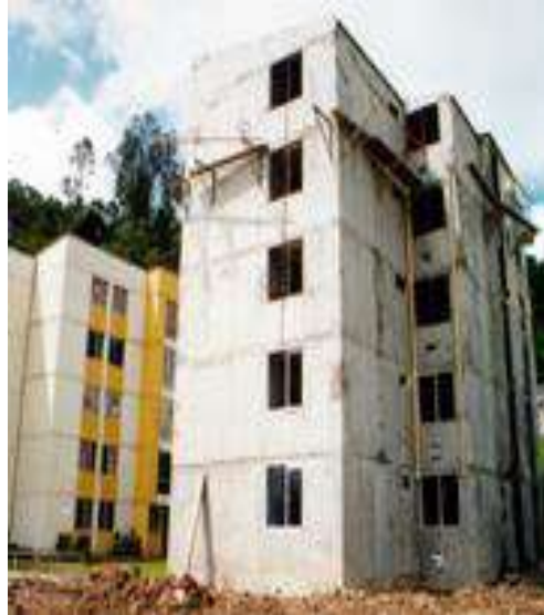
Imagen 67: sistema constructivo muros vaciados en concreto reforzado posmoderno, Edificios en altura. Conjunto Residencial Estambul.
