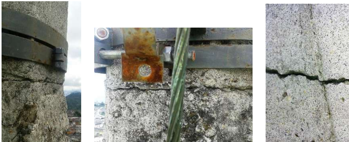
Fracturas estructurales en la punta de coronación de la torre nororiental
