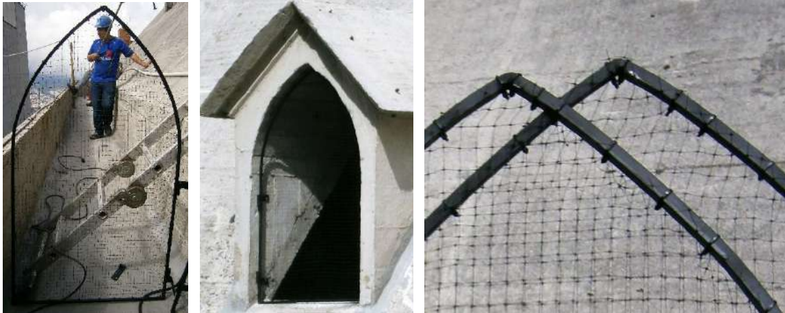
Cerramientos contra palomas y aves: marcos metálicos, malla Birdnet, amarres
