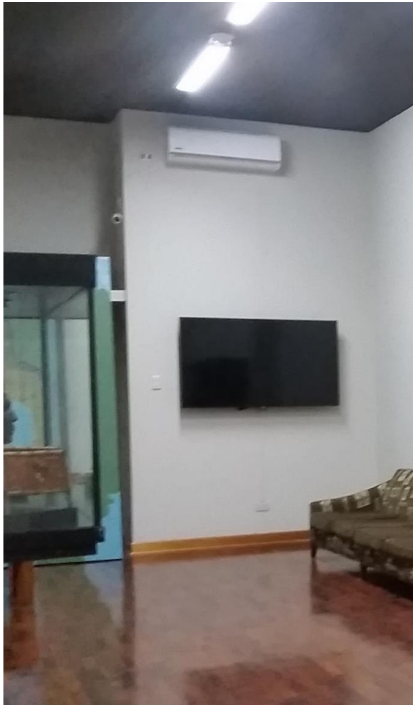
Figura 2-4: Ubicación de Aire acondicionado en sala
