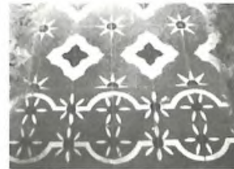
F111. Baldosa de cemento deteriorada por la intemperie y por mal mantenimiento
