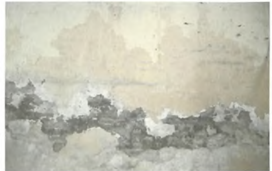
Efectos de humedad ascendente con eflorescencia
