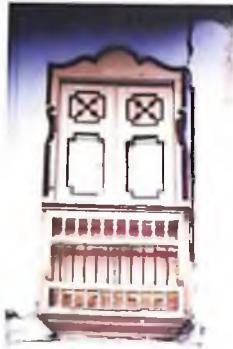
F102. Esta grieta se produjo por asentamientos en el predio vecino.
