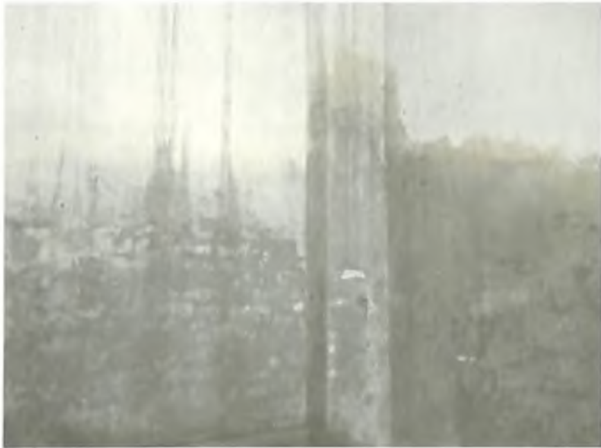
Efectos producidos por la humedad en el muro
