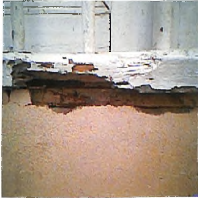
F107. Madera deteriorada por ataque de insectos.
