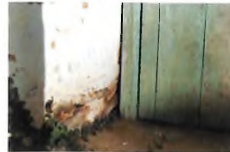
F104. Pequeñas plantas que crecen en la base de un muro de tapia propiciado por la humedad del suelo y del ambiente.
