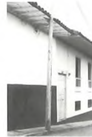
F109. Alero roto por instalar un poste causando graves daños en la construcción.
