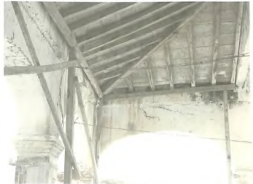
Fuga de la Catedral - Efectos de la humedad
