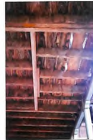
F106. Entresuelo con vigas de madera aserrada que se deterioran por humedad por falta de adecuada ventilación. También se ve un agregado con madera nueva que cambio el ritmo estructural de la viguetería.
