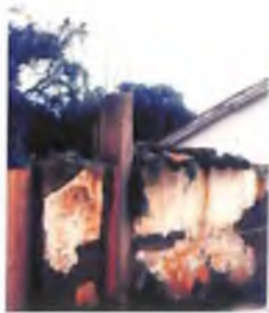
F103. Muro de tapia intervenido indebidamente.
