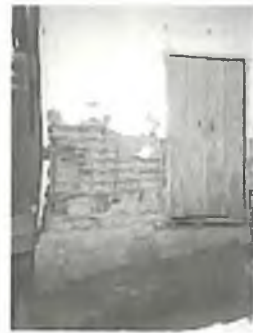
F110. Muro de bahareque que presenta desprendimiento de revoque por falta de mantenimiento.
