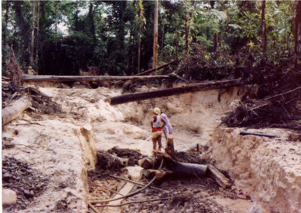
Fotografía 3. Mina de oro en La Villa. Nótese el canalón en la parte inferior.
