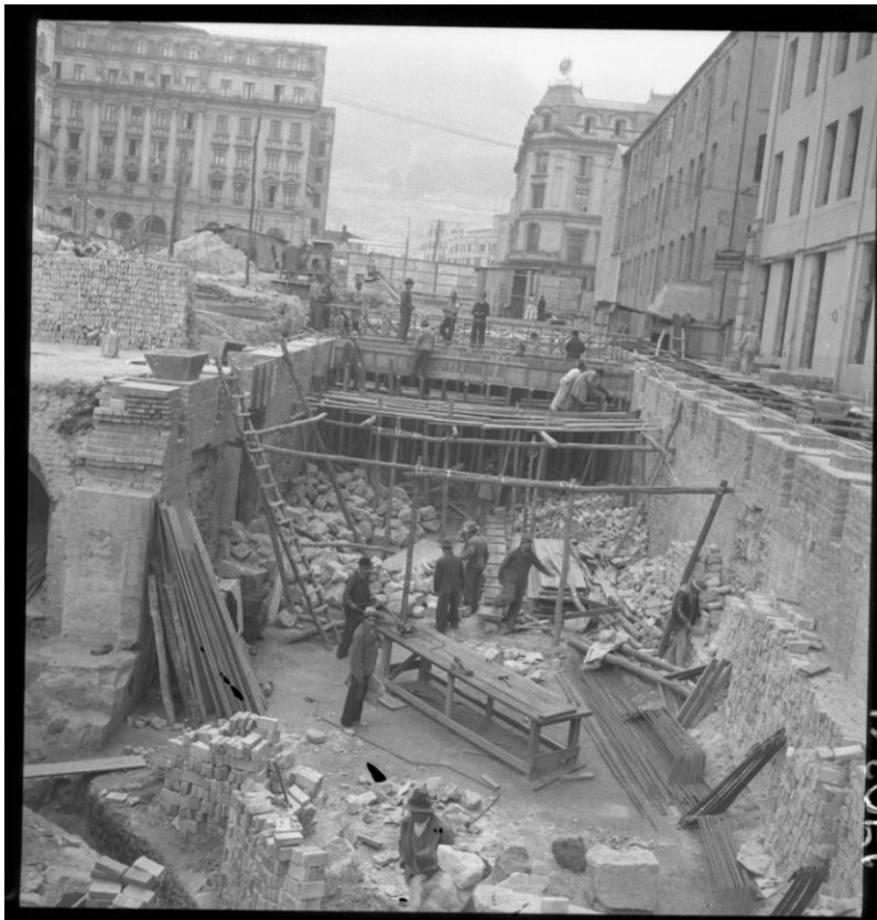
Figura 19. Obras Públicas Avenida Jiménez, construcción del pasaje de San Francisco. En la que podemos apreciar el esfuerzo en este tramo de construcción de la avenida. Tomado de la colección: Museo de Bogotá, fondo: Daniel Rodríguez. Fotografía: Daniel Rodríguez. Circa 1940.
