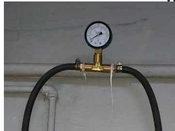
Compresor de aire
