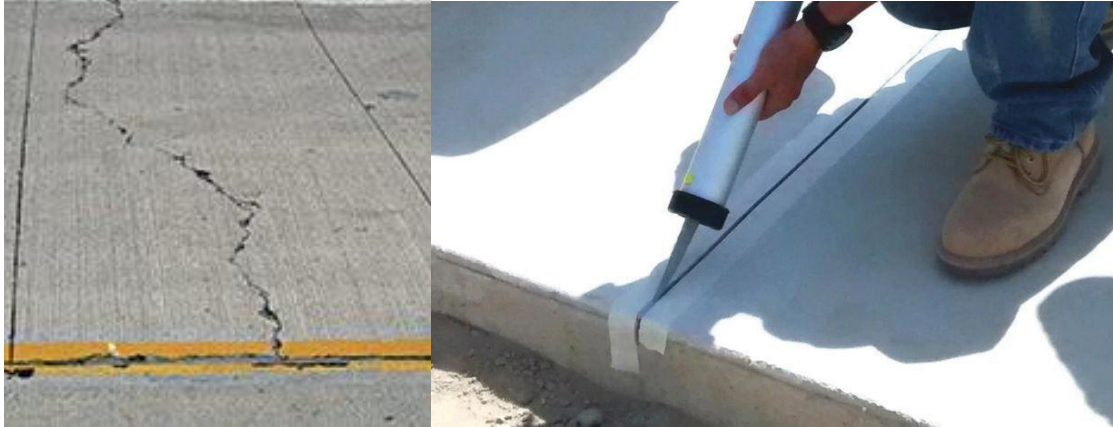
Figura 6-6. Dilataciones en las losas de cemento
