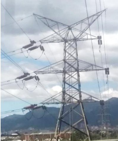
Figura 11. Torre de retención.
