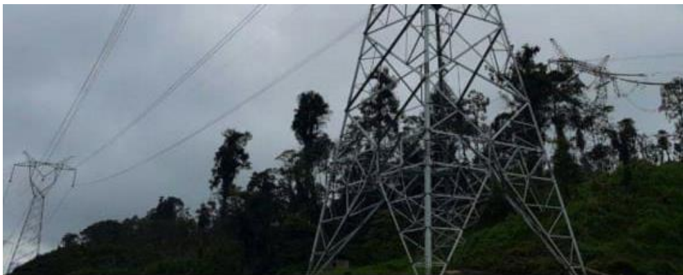
Figura 185. Lugar de instalación en la torre de transmisión
