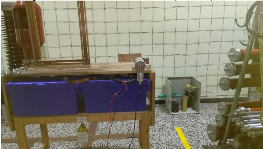
Figura 212. Instalación de la bobina para las pruebas
