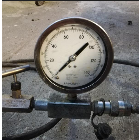
Figura 3-12. Manómetro marca ASHCROFT para medir la presión aplicada por la bomba. Elaboración propia.
