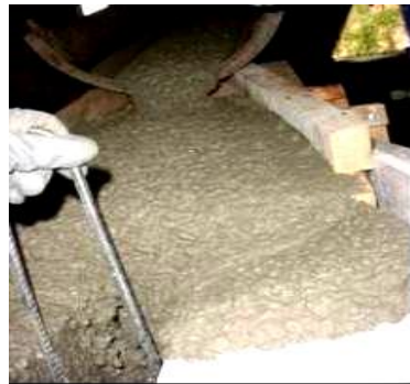
Fotografía. 2.3 Llenado de los moldes para las vigas de HAC-RM (prueba) sin armadura. (De La Cruz, 2006)
