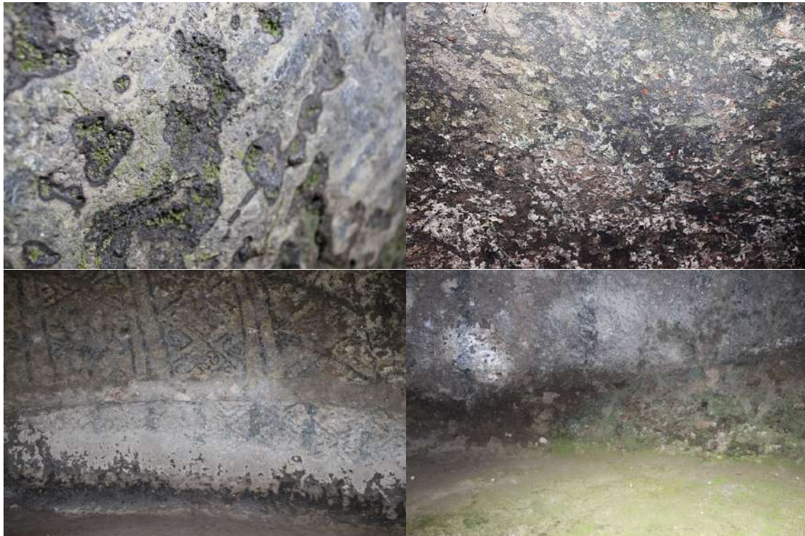
Figuras 6-9, 6-10, 6-11 & 6-12: Biodeterioro ocasionado por algas.
