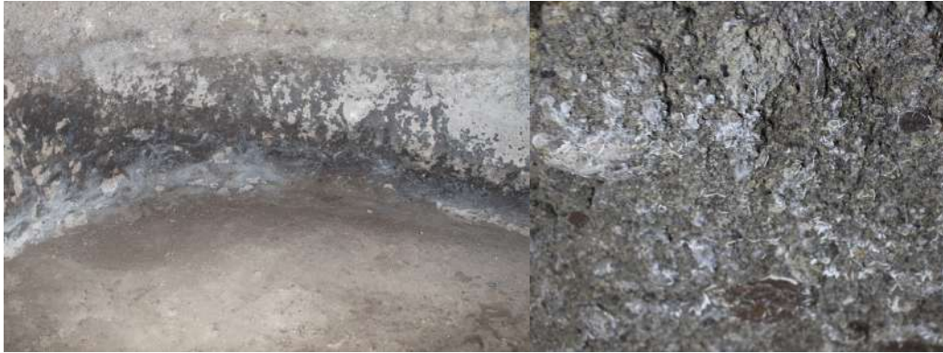
Figura 6-6 & 6-7: Presencia de velos salinos. Hipogeo AR-38.
