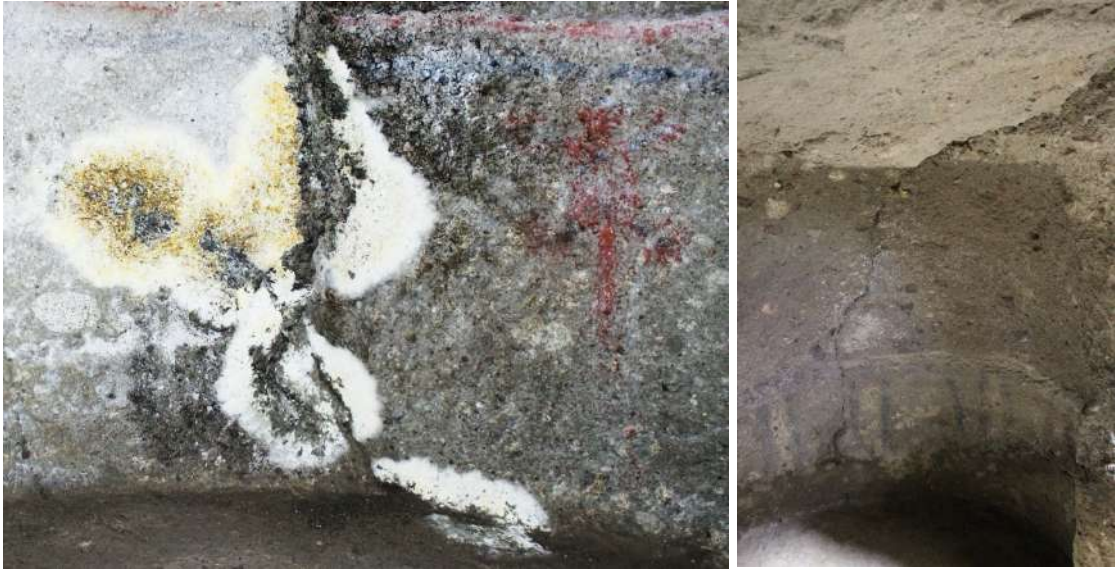
Figuras 6-15 & 6-16: Grietas en los Hipogeos A-0 y AR-50.
