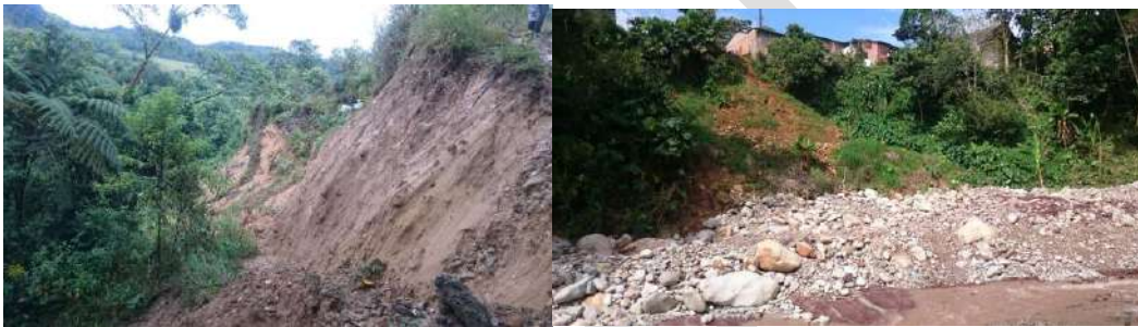
Figura 105. Procesos morfodinámicos en la cuenca media del río Mulato. A la izquierda deslizamiento traslacional en rocas del Grupo Orito. A la derecha deslizamiento traslacional en los depósitos fluviotorrenciales aterrazados.
