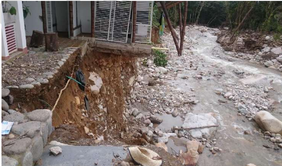
Figura 106. Socavación lateral del río Mulato por flujo de alta energía en la parte externa de una curva en la vereda el Líbano (E=1.045.719 N=618.412).
