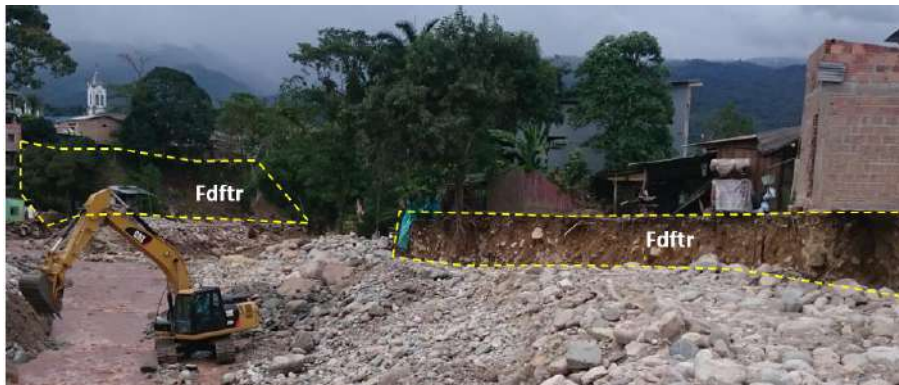
Figura 89. Depósitos fluvio-torrenciales aterrizados a ambos costados del río Mulato.
