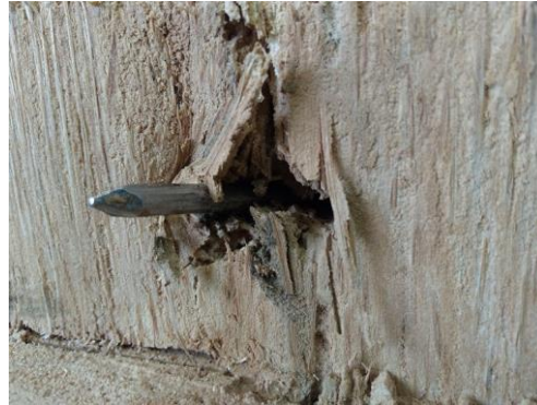
Figura 3-14. Falla típica - unión a corte
