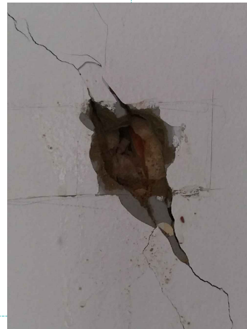
EXPLORACIÓN 3 Pañete de cemento.
