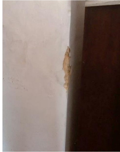
Figura 222. Impacto en filo de muro salón bajo.
