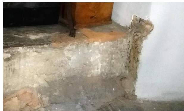
Figura 224. Erosión muro sur cuarto del reloj.
