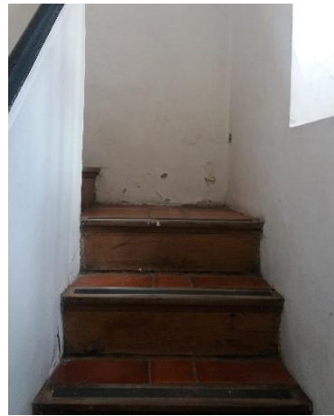
Figura 217. Humedad por capilaridad primer piso torre escalera.
