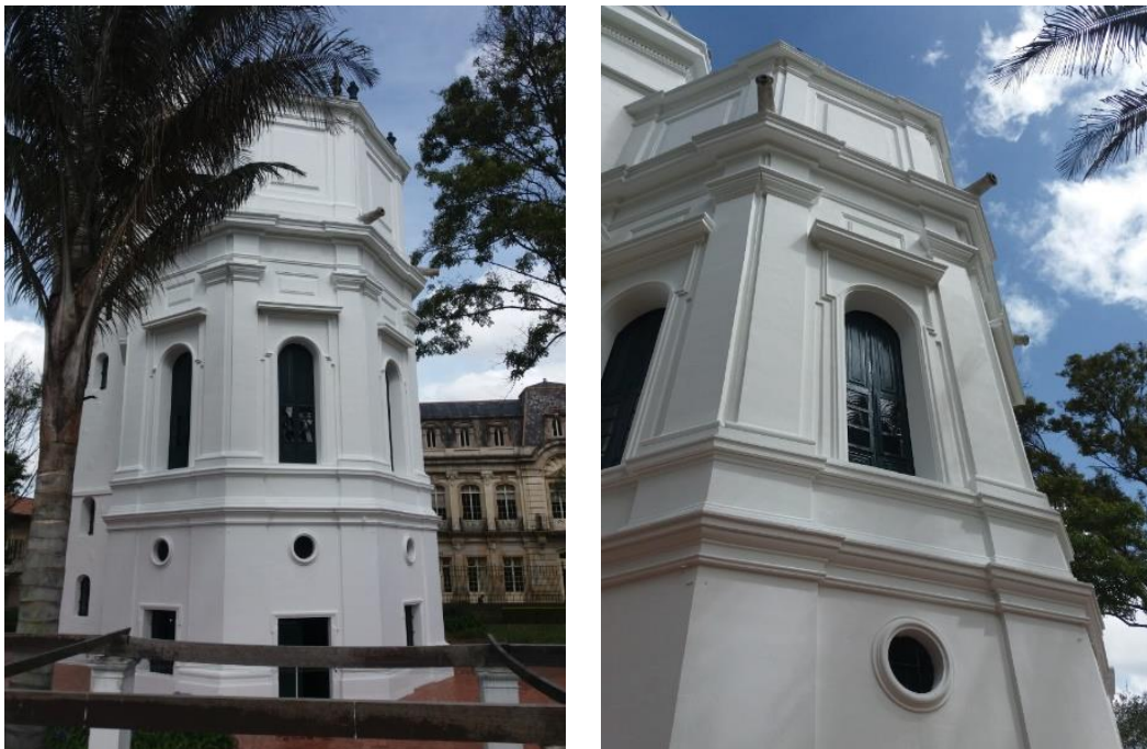
Figura 209. Estado de conservación de las fachadas
