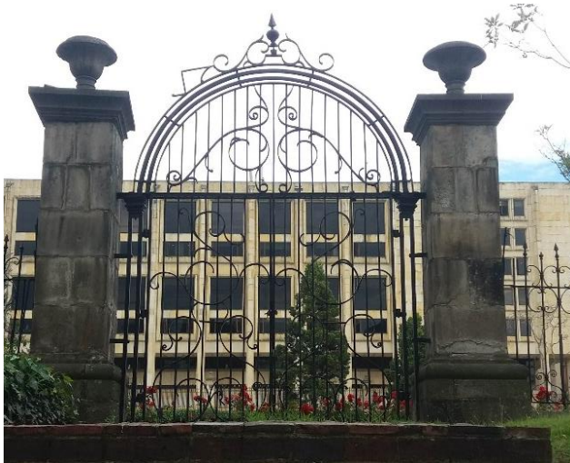
Figura 198. Manchas sobre el Acceso principal
