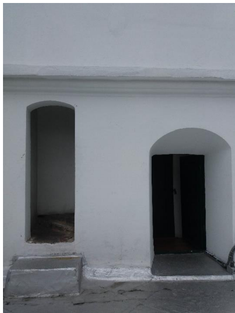
Figura 117. Puerta de la terraza (der) y vano que conduce al cuarto del astrónomo (izq). Fuente: Elaboración propia.
