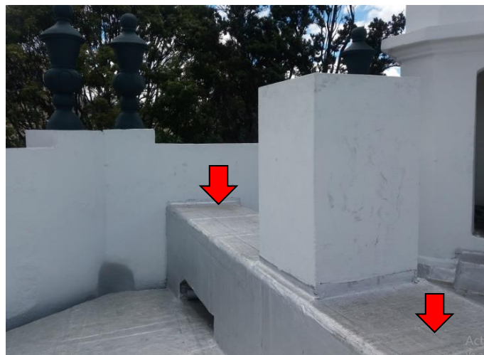
Figura 234. Desprendimiento de pintura por filtración
