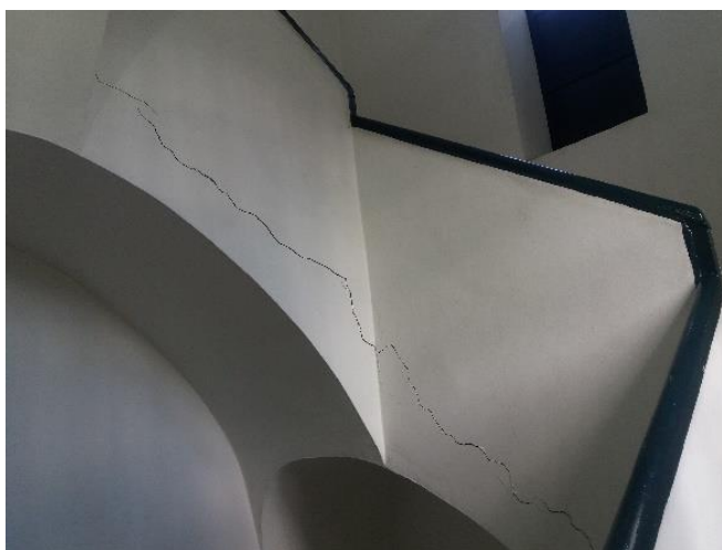
Figura 241. Junta natural parte baja del pasamanos de la escalera tipo 1.
