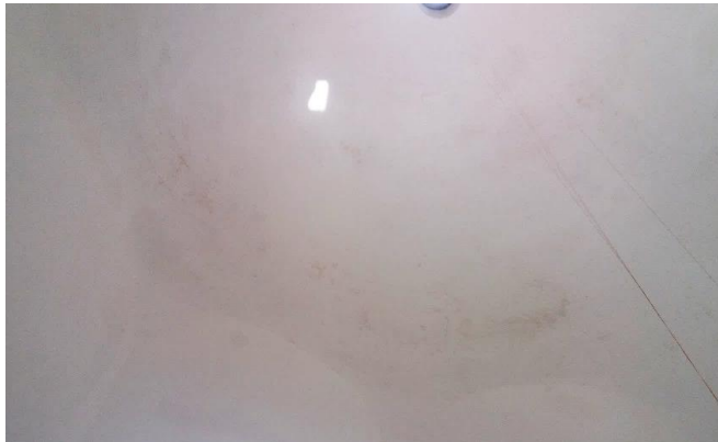
Figura 232. Mancha de humedad por filtración en cúpula de entrepiso de terraza.
