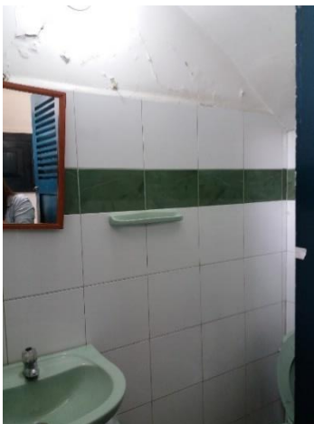
Figura 219. Humedad por capilaridad.
