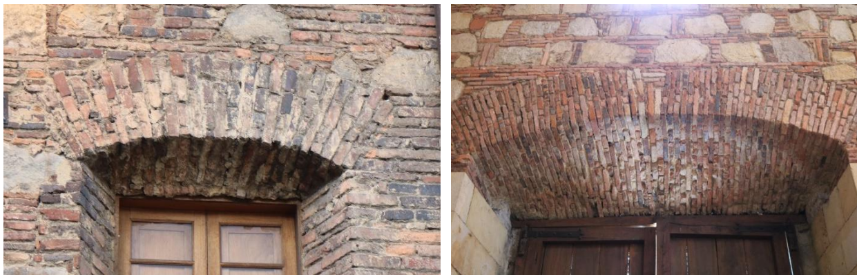
Figura 28. Comparativo de vanos de ventanas catedrales de Bogotá (izq.) y Zipaquirá (der.)
