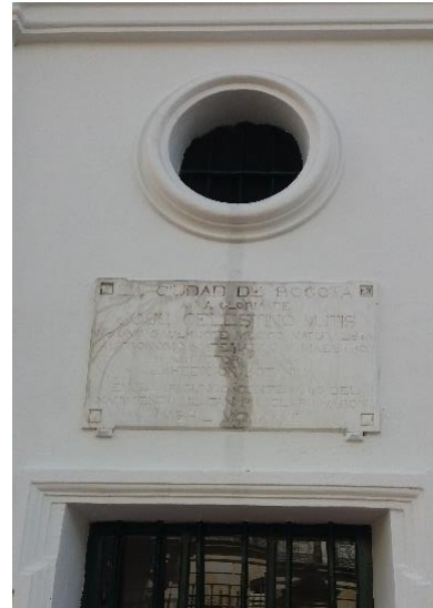
Figura 211. Suciedad de fachadas.
