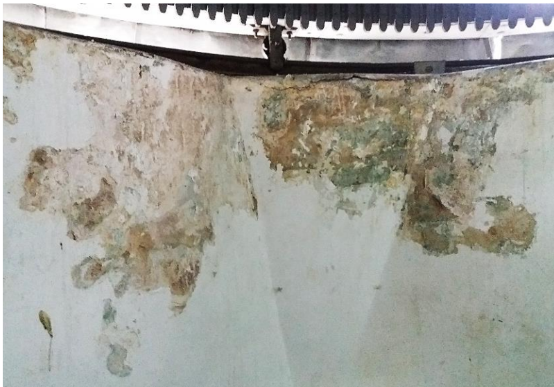
Figura 227. Patología en muros en el cuarto del telescopio.
