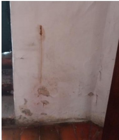
Figura 214. Humedad muros salón bajo.
