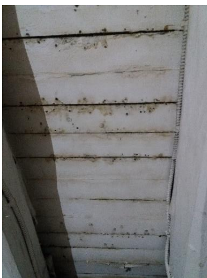
Figura 238. Manchas por filtración Fuente: Elaboración propia
