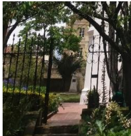
Figura 199. Faltante de reja
