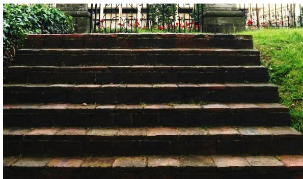
Figura 202. Presencia de afectaciones biológicas.
