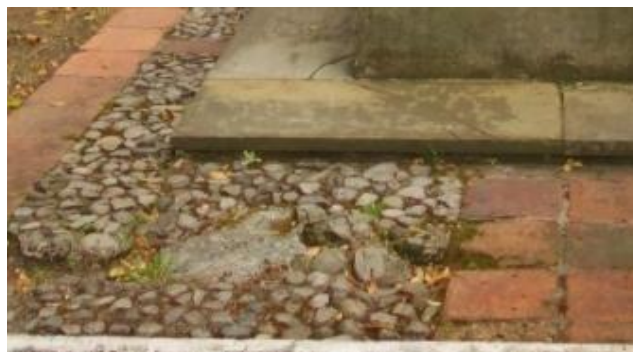
Figura 203. Desnivel y faltante de acabado.
