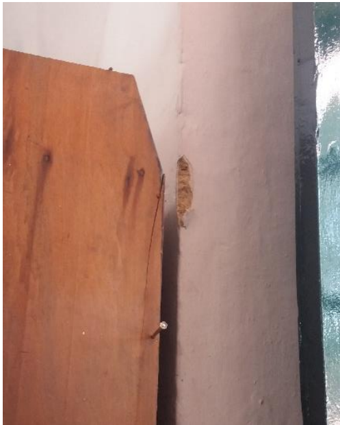
Figura 221. Impacto en filo de muro salón bajo.
