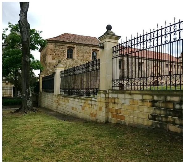
Figura 197 Humedad por acumulación cerramiento
