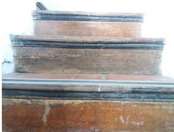
Figura 242. Detalle patologías escalera principal.
