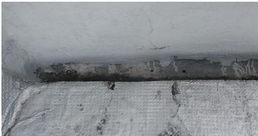
Figura 231. Detalle del foil de aluminio mal instalado.
