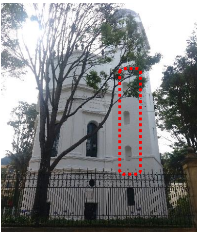
Figura 225. Presencia de vanos tapiados Fuente: Elaboración propia
