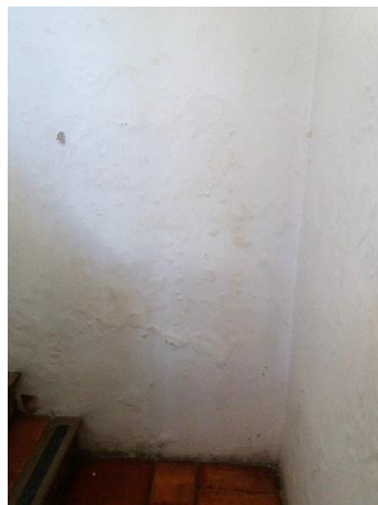
Figura 216. Humedad por capilaridad primer piso torre escalera.
