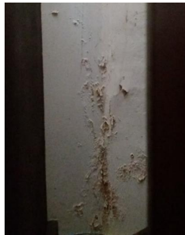
Figura 215. Eflorescencias muros salón bajo.
