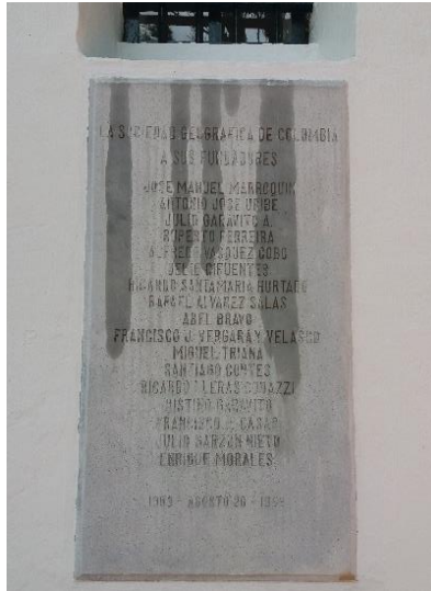
Figura 210. Suciedad de fachadas.
