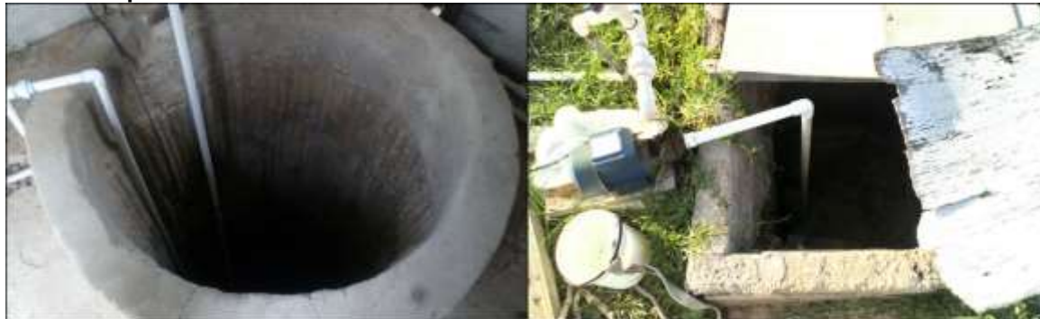
Foto 2-19: pozos artesanales con sistema de bombeo.
