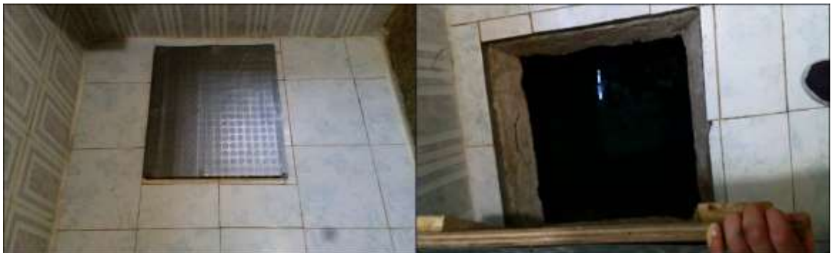
Foto 2-23: cisterna subterránea en La Loma.
