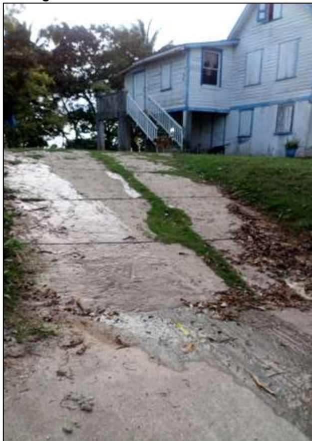
Foto 2-25: fuga interna de agua en El Cove.
