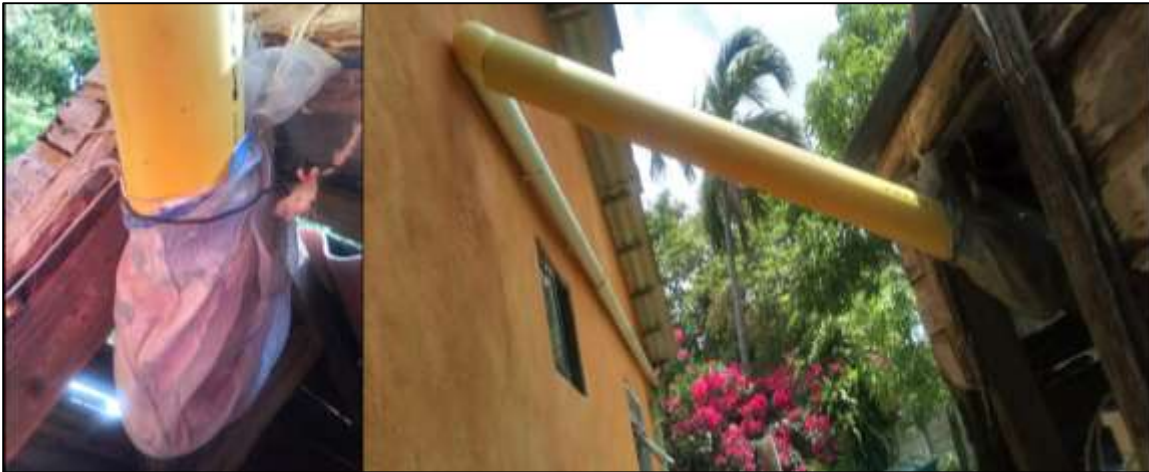
Foto 2-2: canales y filtros para el agua lluvia.
