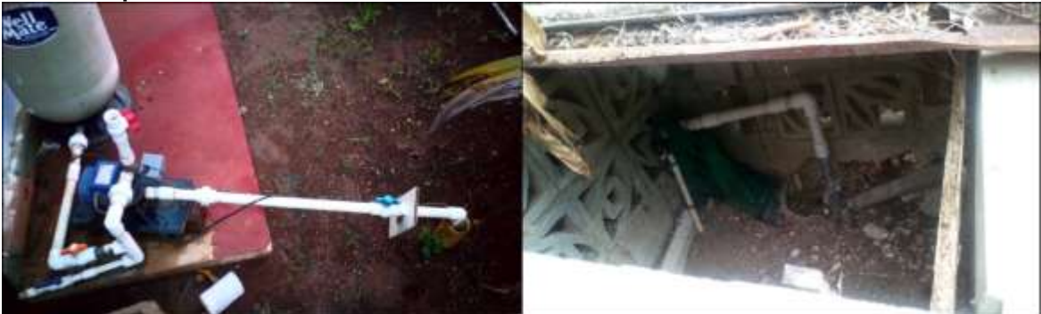
Foto 2-10: pozos barrenos en San Luis.
