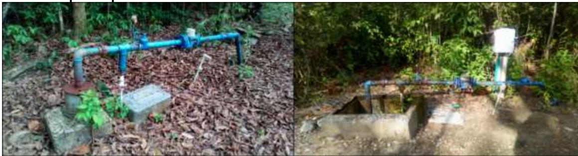
Foto 2-11: pozos profundos del acueducto.
