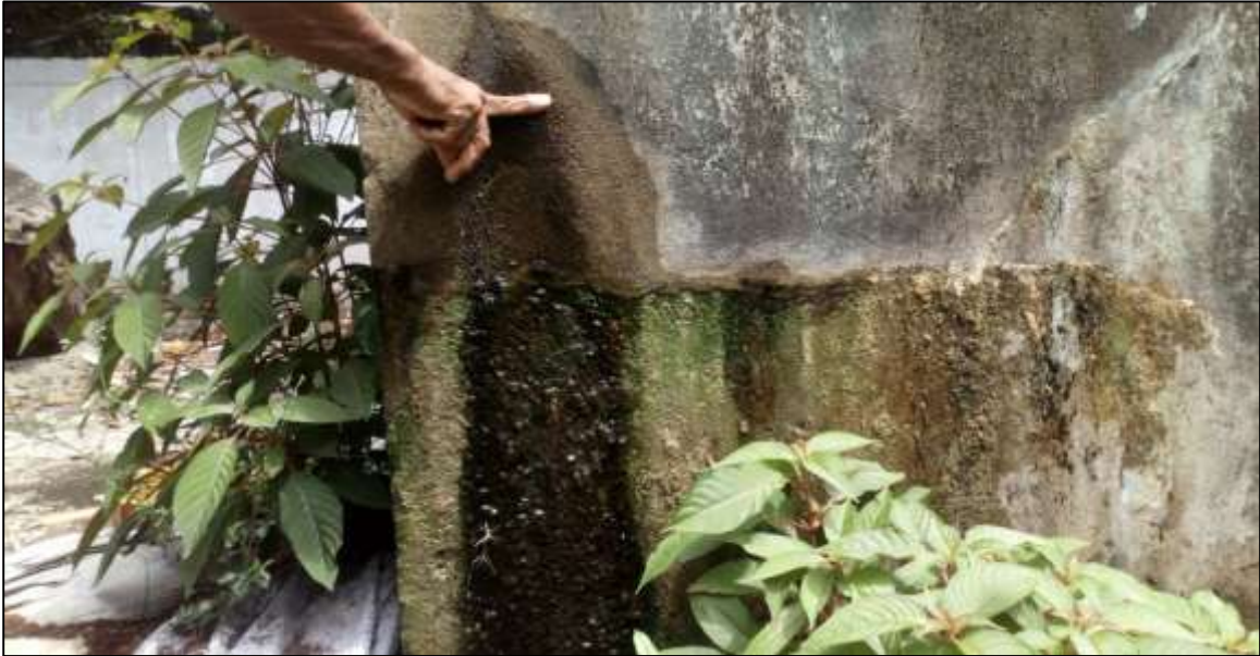
Foto 2-20: fuga de agua en cisterna antigua.
