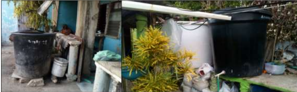
Foto 2-4: canales conectadas a tanques.
