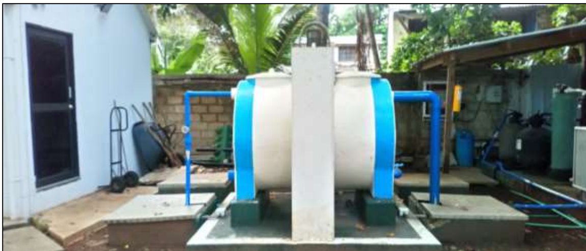
Foto 2-18: planta de tratamiento de aguas residuales (PTAR) de la Sede Caribe de la Universidad Nacional.
