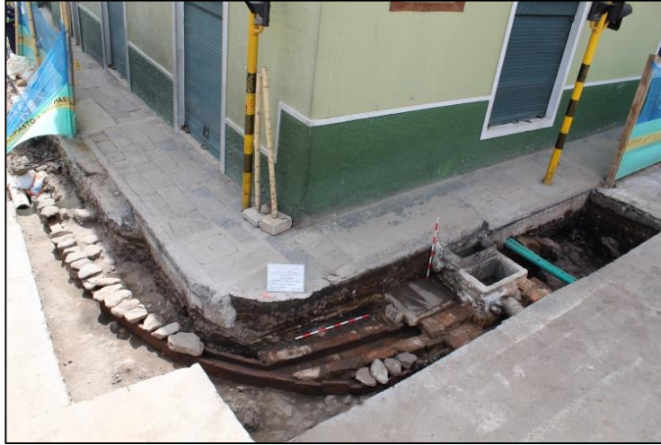
Fotografía 4-5: Canales inferiores. Sistema hidrosanitario. Cra27 calle 14.
