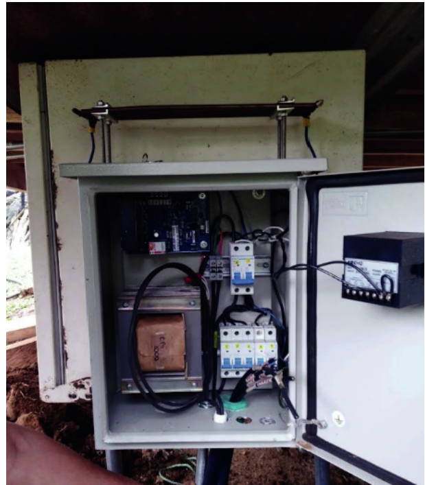
Figura 22. Breakers caja de control. Microturbina "La Elvira". Fuente: Propia.
