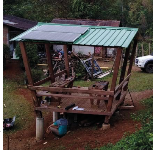
Figura 5. Paneles solares instalados en el módulo “El Águila Solar”. Fuente: Propia.
