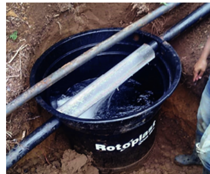
Figura 15. Cámara de carga de la microturbina "La Elvira". Fuente: Propia.
