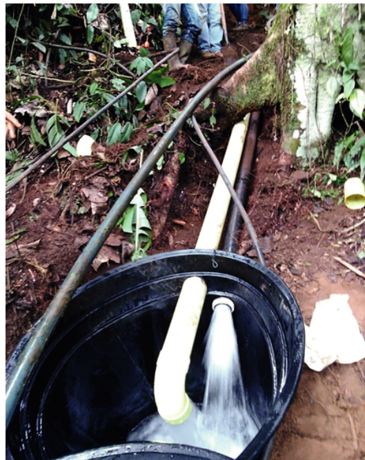
Figura 20. Cámara de descarga. Microturbina "La Elvira". Fuente: Propia.
