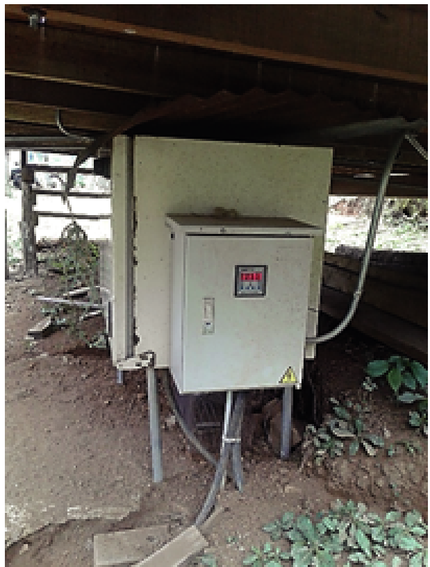
Figura 23. Caja de control eléctrico. Microturbina "La Elvira". Fuente: Propia.
