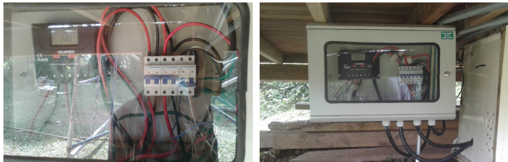
Figura 6. Regulador del Módulo “El Águila solar”. Fuente: Propia.
