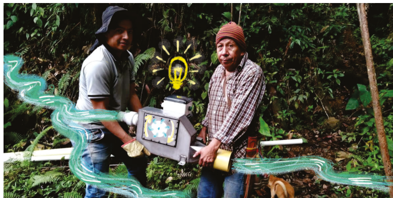
Figura 13. Microturbina hidráulica “La Elvira”. Fuente: Propia.
