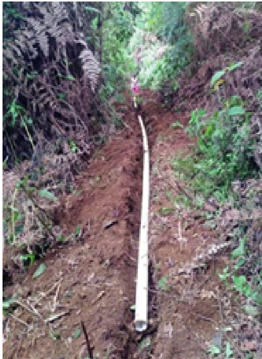
Figura 16. Tubería de presión. Microturbina “La Elvira”. Fuente: Propia
