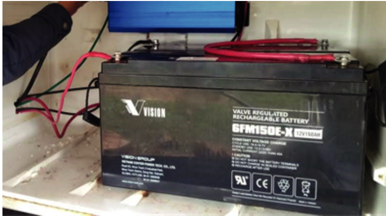
Figura 7. Baterías del Águila solar. Fuente: Propia
