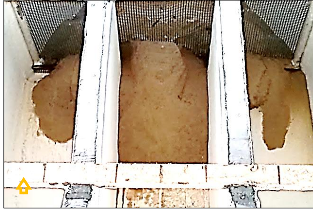
Figura 11-14. Depósito en los canales de cribado. Caudal Medio y Abastecimiento Alto.
