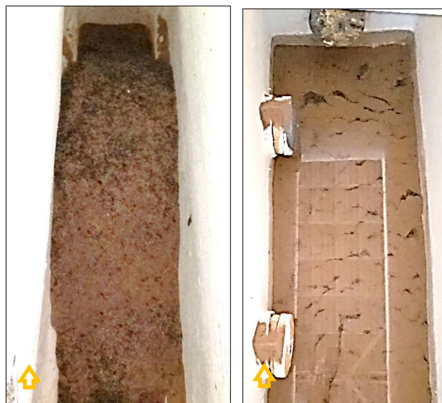
Figura 11-16. Acumulación de sedimentos excluidos (izq.) y cárcamos de bombeo (der.). Caudal Medio y Abastecimiento Alto.
