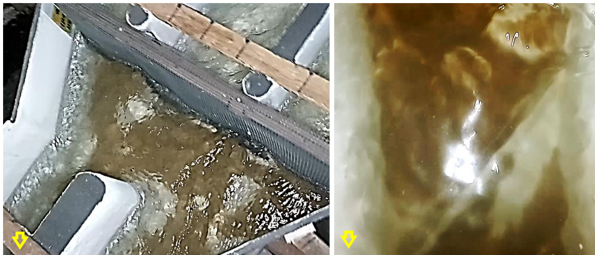
Figura 11-9. Depósito luego de reja de cribado (izq.) y cerca de los excluidores (der.). Caudal Medio y Abastecimiento Medio
