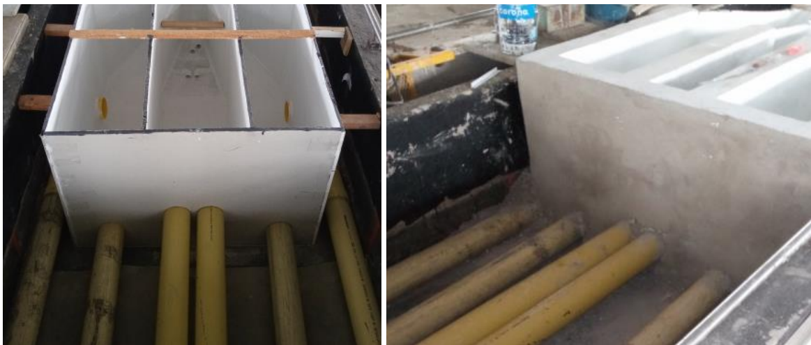
Figura 8-6. Cárcamos de bombeo y foso de sedimentos; original en Dry Wall (izq.), y final en mampostería (der.)
