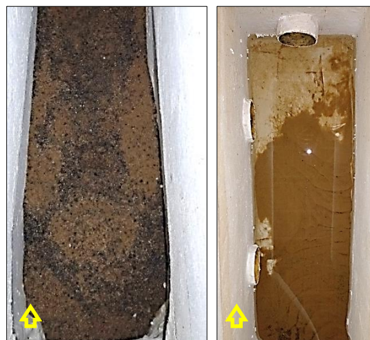
Figura 11-36. Sedimentos excluidos (izq.) y cárcamos de bombeo (der.). Caudal Máximo y Abastecimiento Alto
