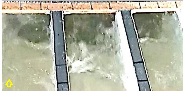
Figura 11-34. Depósitos en los canales de cribado. Caudal Máximo y Abastecimiento Alto
