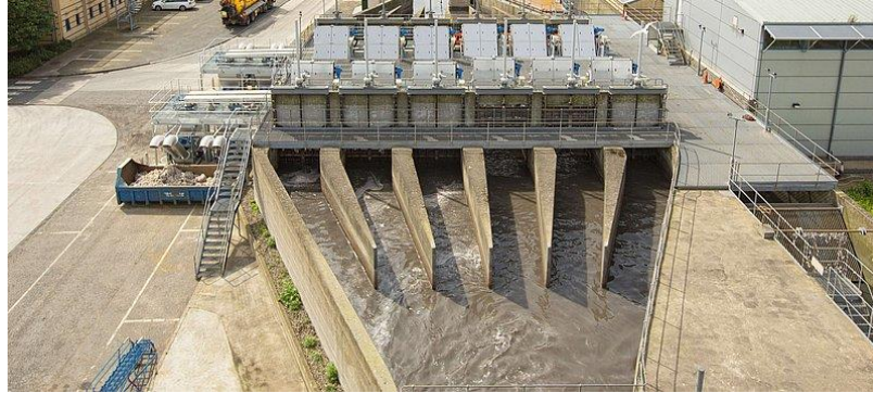
Figura 5-8. Vista frontal estructura y muros deflectores. (Huber Technology, 2015)
