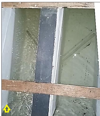
Figura 10-5. Comportamiento general canales de conexión. Caudal Bajo
