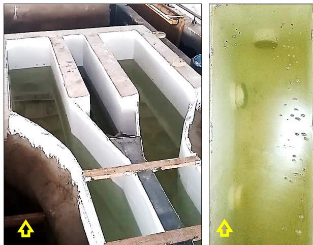
Figura 10-4. Comportamiento general cárcamos de bombeo. Caudal Bajo
