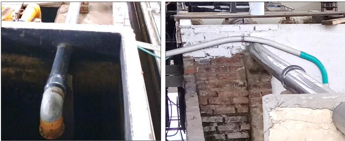
Figura 4-4. Entrega de agua al tanque de entrada UISA.
