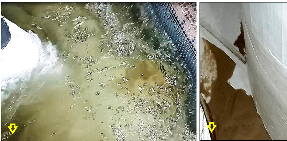
Figura 11-30. Depósito luego de reja de cribado (izq.) y cerca de los excluidores (der.). Caudal Máximo y Abastecimiento Medio
