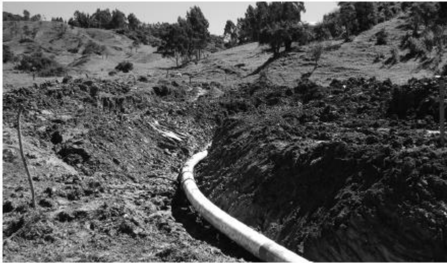
Figura 1-2: Tubería flexionada por efecto geotécnico. [41]
