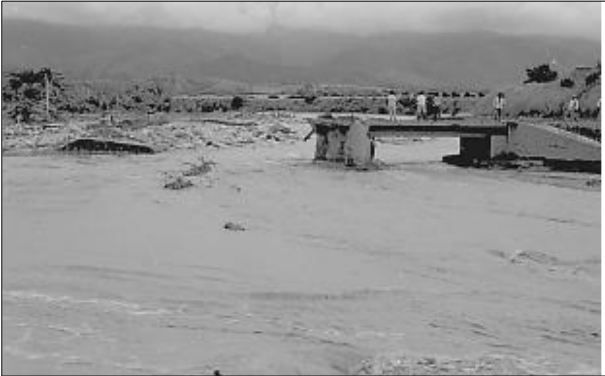
Figura 2. Puente destruido por la avenida torrencial en la cuenca del río Fraile. Fuente: González, Chavez, & Hermelin, (2005)
