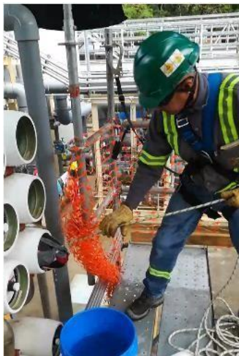
Imagen 5. Limpieza de los vasos de presión en el sistema de osmosis inversa.
