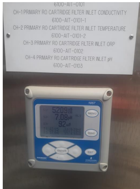
Imagen 11. Tablero de parámetros y flujo metro.
