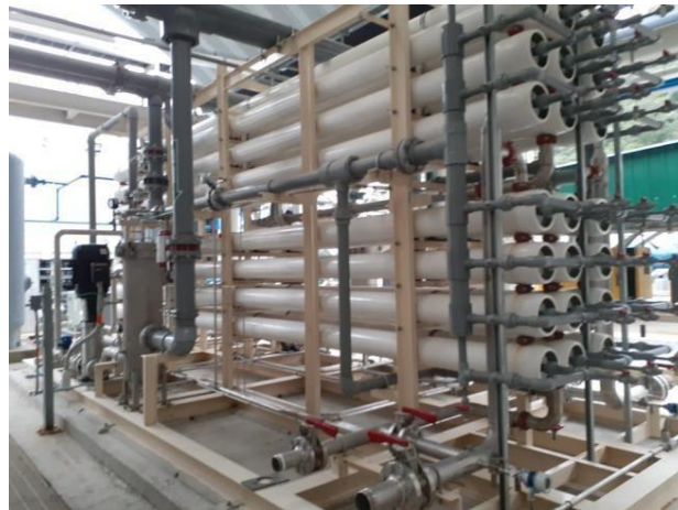
Imagen 9. Membranas de la unidad de osmosis inversa.
